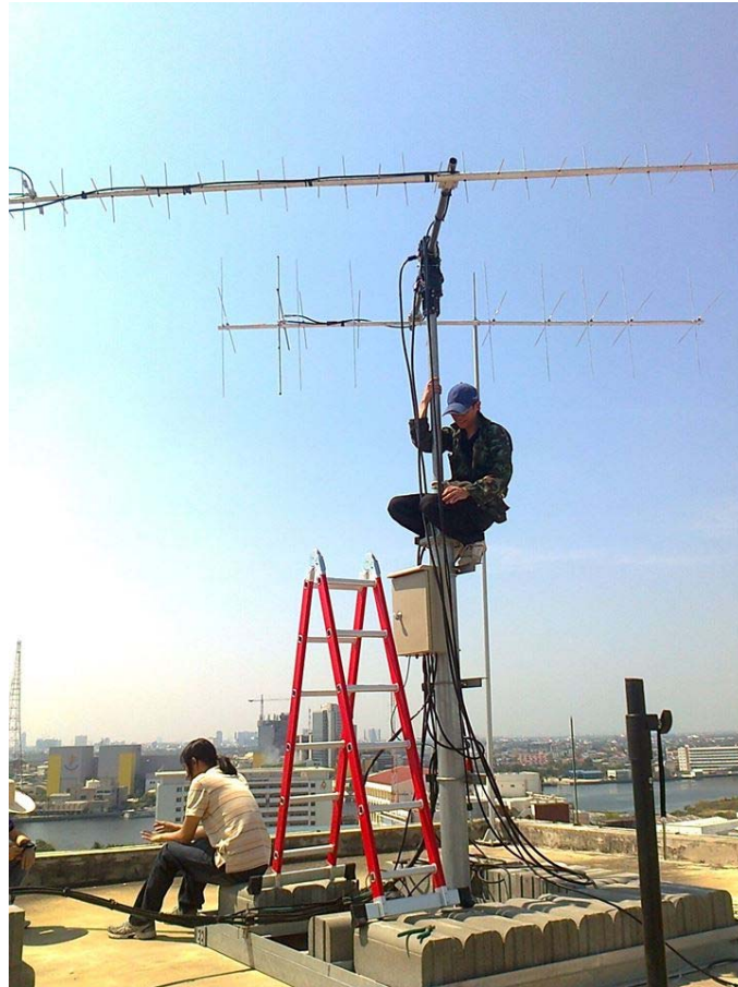
รูปที่ 9.2 การติดตั้ง Rotator และสายอากาศสำหรับรับส่งสัญญาณ ที่บริเวณดาดฟ้าอาคาร
