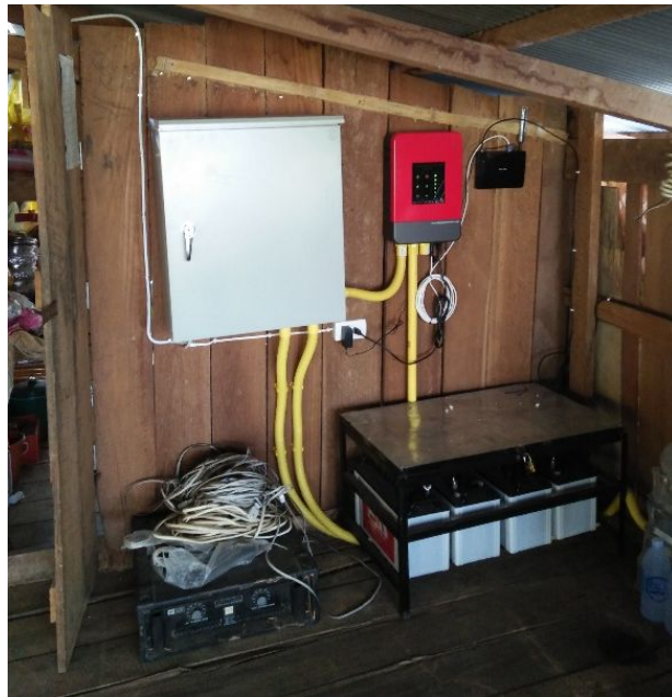
รูปที่ ก๕๓ ระบบไฟฟ้าพลังงานแสงอาทิตย์และระบบส่งเหตุการณ์ ณ ระบบฯ จุดที่ ๙
