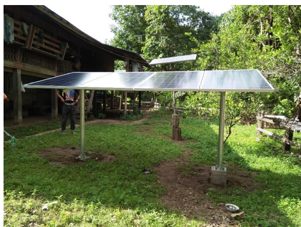
รูปที่ ก๔๔ แผงเซลล์แสงอาทิตย์ที่ติดตั้ง ณ ระบบฯ จุดที่ ๗
