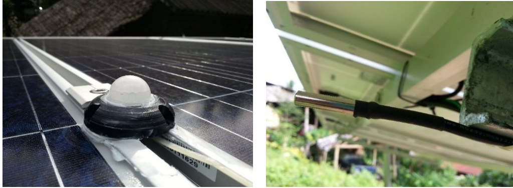
รูปที่ ๓๖ อุปกรณ์ตรวจจับความเข้มแสง และอุณหภูมิ ที่ติดตั้งที่แผงเซลล์แสงอาทิตย์
