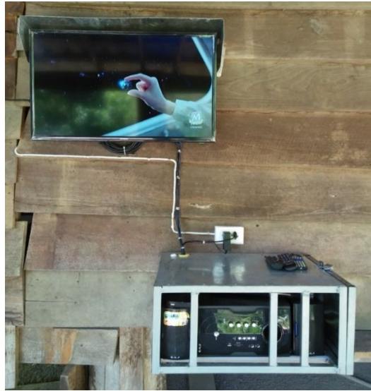
รูปที่ ๓๘ อุปกรณ์ระบบการสื่อสารด้วยภาพและเสียงที่ติดตั้ง ณ ระบบฯ จุดที่ ๑
