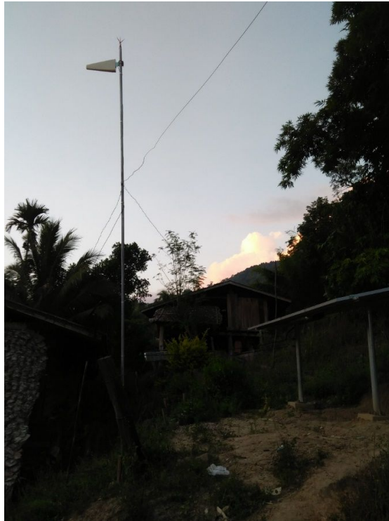
รูปที่ ๓๒๖ อุปกรณ์รับสัญญาณโทรศัพท์ที่ติดตั้ง ณ ระบบฯ จุดที่ ๓
