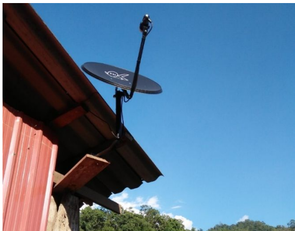
รูปที่ ๓๙ อุปกรณ์รับสัญญาณภาพและเสียงผ่านดาวเทียมที่ติดตั้ง ณ ระบบฯ จุดที่ ๑
