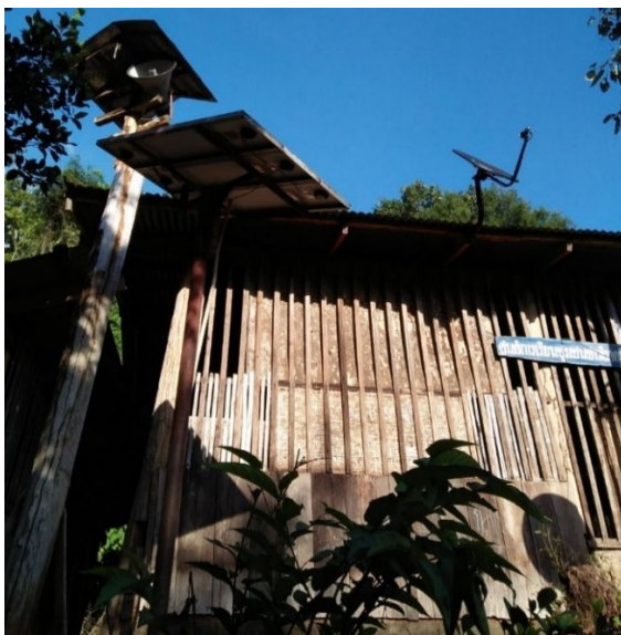
รูปที่ ก๑๙ อุปกรณ์รับสัญญาณภาพและเสียงผ่านดาวเทียมที่ติดตั้ง ณ ระบบฯ จุดที่ ๒
