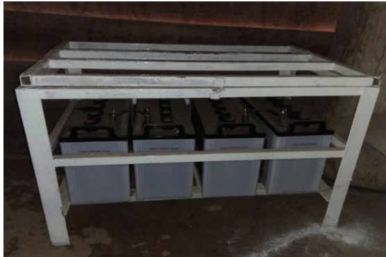
รูปที่ ๓๒๔ แบตเตอรี่สำรองไฟ ที่ติดตั้ง ณ ระบบฯ จุดที่ ๓
