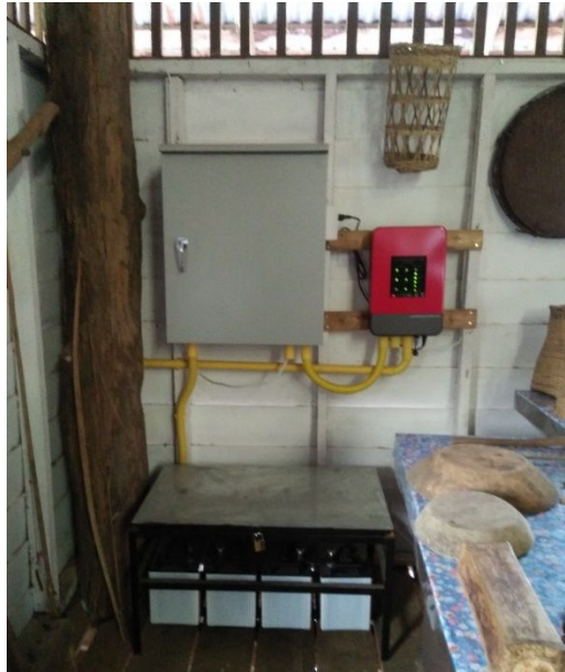
รูปที่ ๓๖๙ ตู้ควบคุมระบบไฟฟ้าพลังงานแสงอาทิตย์และระบบส่งเหตุการณ์ ณ ระบบฯ จุดที่ ๑๓
