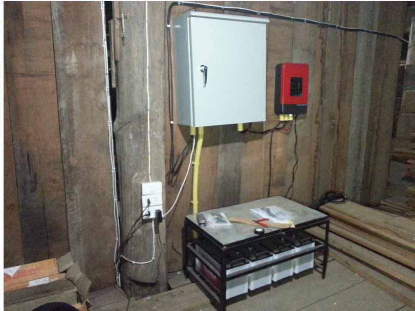
รูปที่ ก๗๗ ตู้ควบคุมระบบไฟฟ้า ระบบส่งเหตุการณ์ และแบตเตอรี่ ๓ ระบบฯ จุดที่ ๑๕
