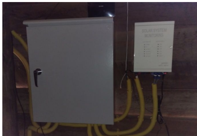
รูปที่ ก๒๓ ตู้ควบคุมระบบไฟฟ้าพลังงานแสงอาทิตย์ ระบบสังเกตการณ์ ที่ติดตั้ง ณ ระบบฯ จุดที่ ๓
