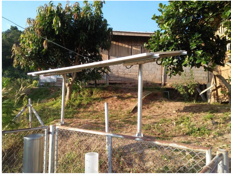
รูปที่ ๓๕๖ แผงเซลล์แสงอาทิตย์ที่ติดตั้ง ณ ระบบฯ จุดที่ ๑๐
