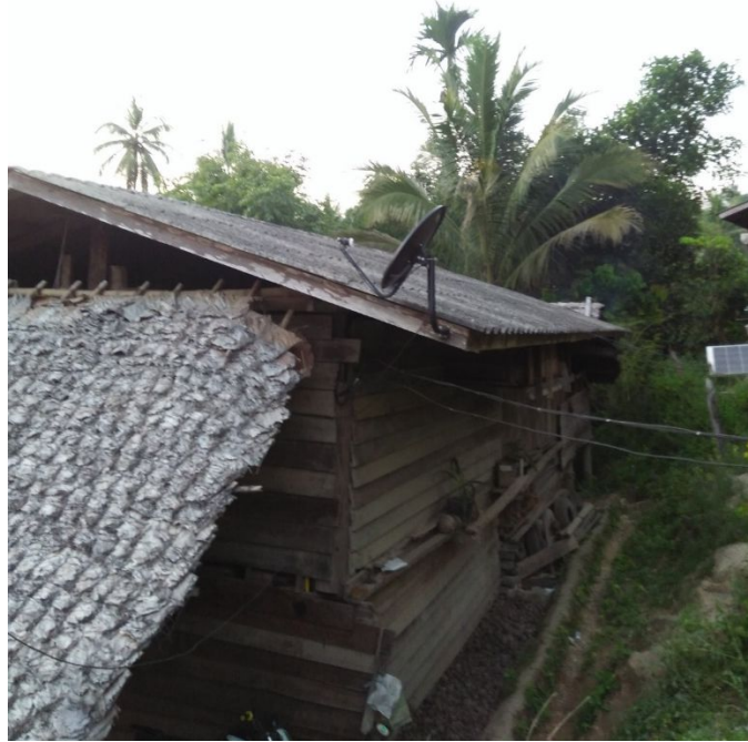
รูปที่ ๓๒๘ อุปกรณ์รับสัญญาณภาพและเสียงผ่านดาวเทียมที่ติดตั้ง ณ ระบบฯ จุดที่ ๓
