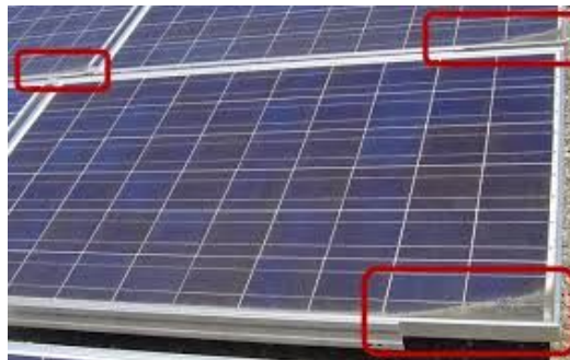
รูปที่ ๙ คราบบนแผงพลังงานแสงอาทิตย์ที่เกิดจากการขังของน้ำ
