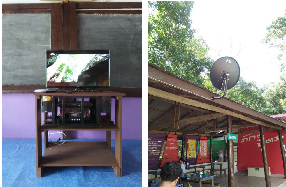
รูปที่ ๓๓๓ อุปกรณ์ระบบการสื่อสารด้วยภาพและเสียงที่ติดตั้ง ณ ระบบฯ จุดที่ ๔
