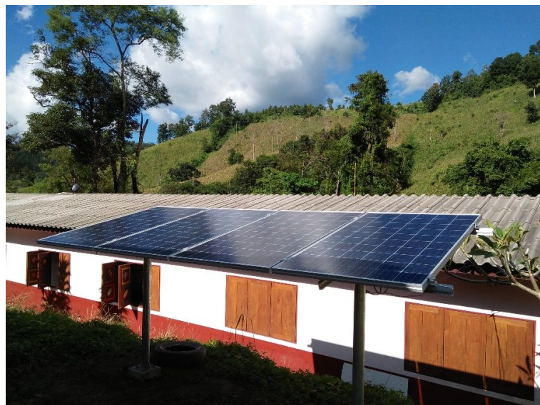
รูปที่ ก๔๘ แผงเซลล์แสงอาทิตย์ที่ติดตั้ง ณ ระบบฯ จุดที่ ๘
