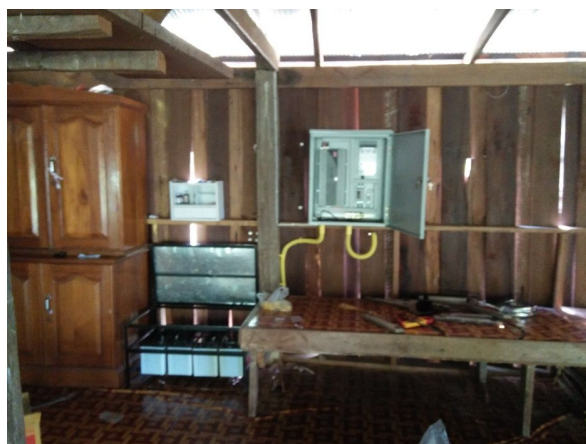
รูปที่ ๓๓๖ ระบบไฟฟ้าพลังงานแสงอาทิตย์ที่ติดตั้ง ณ ระบบฯ จุดที่ ๕
