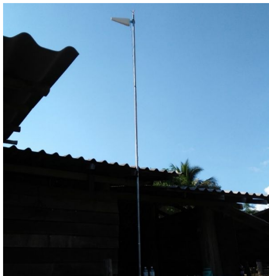
รูปที่ ๓๗ อุปกรณ์รับสัญญาณโทรทัศน์ที่ติดตั้ง ณ ระบบฯ จุดที่ ๑
