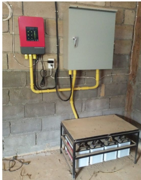
รูปที่ ก๖๑ ระบบไฟฟ้าพลังงานแสงอาทิตย์ และระบบส่งเหตุการณ์ ณ ระบบฯ จุดที่ ๑๑
