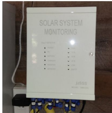
รูปที่ 7 ตู้ควบคุมระบบสังเกตการณ์ที่บรรจุอุปกรณ์ที่รายการ (8) (10) (11) (12) (13) ที่ติดตั้ง ณ ระบบจุดที่ 1
