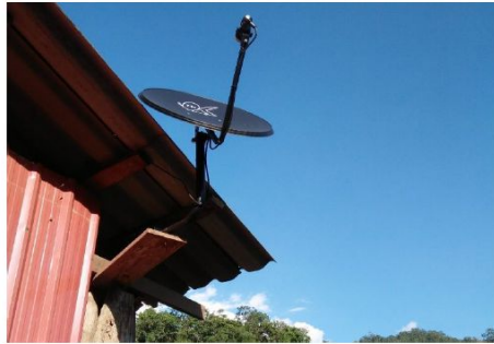
รูปที่ 10 ตัวอย่างการติดตั้งจานรับสัญญาณดาวเทียม ณ ระบบที่ อบต.1
