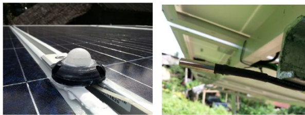
รูปที่ 8 ตัวอย่างการติดตั้ง Pyranometer Sensor ณ ระบบจุดที่ 1
