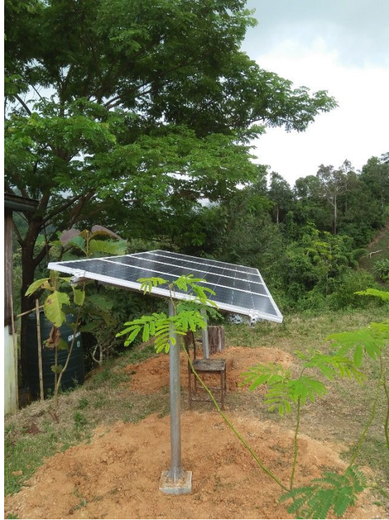
รูปที่ ๓๓๕ แผงเซลล์แสงอาทิตย์ที่ติดตั้ง ณ ระบบฯ จุดที่ ๕
