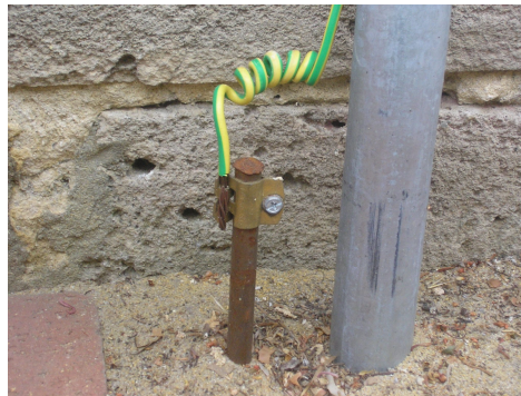
รูปที่ ๑๔ สายดินที่อยู่ในสภาพปกติ
