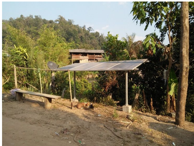
รูปที่ ๓๗๒ แผงเซลล์แสงอาทิตย์ที่ติดตั้ง ณ ระบบฯ จุดที่ ๑๔
