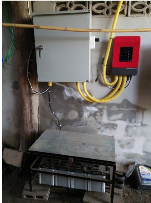
รูปที่ ก๔๑ ระบบไฟฟ้าพลังงานแสงอาทิตย์และระบบส่งเหตุการณ์ ที่ติดตั้ง ณ ระบบฯ จุดที่ ๖
