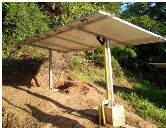
รูปที่ ก๑๒ แผงเซลล์แสงอาทิตย์ที่ติดตั้ง ณ ระบบฯ จุดที่ ๒
