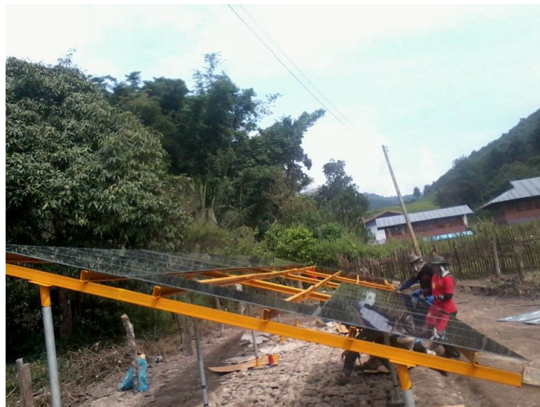
รูปที่ ๗ โครงการระบบไฟฟ้าพลังงานแสงอาทิตย์สำหรับการสาธารณสุขหมู่บ้านในถิ่นทุรกันดาร ณ โรงพยาบาลส่งเสริมสุขภาพตำบล บ้านห้วยโป่ง ต.แม่หละ อ.แม่ระมาด จ.ตาก
