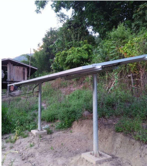
รูปที่ ก๒๒ แผงเซลล์แสงอาทิตย์ที่ติดตั้ง ณ ระบบฯ จุดที่ ๓
