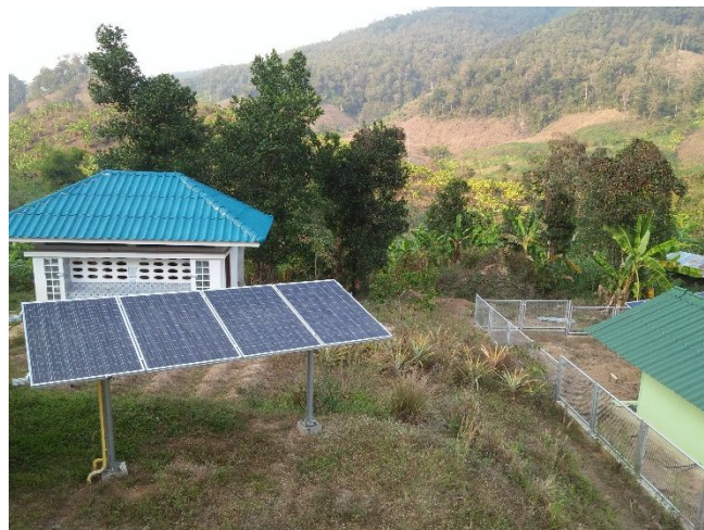
รูปที่ ก๖๘ แผงเซลล์แสงอาทิตย์ที่ติดตั้ง ณ ระบบฯ จุดที่ ๑๓
