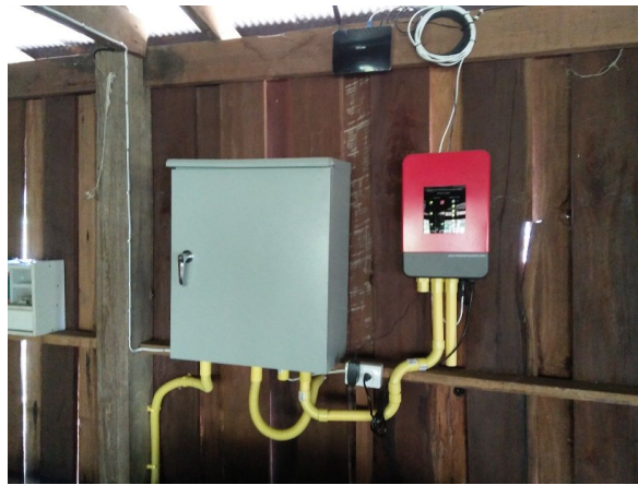
รูปที่ ๓๓๗ ตู้ระบบไฟฟ้าพลังงานแสงอาทิตย์และระบบสั่งเหตุการณ์ ที่ติดตั้ง ณ ระบบฯ จุดที่ ๕
