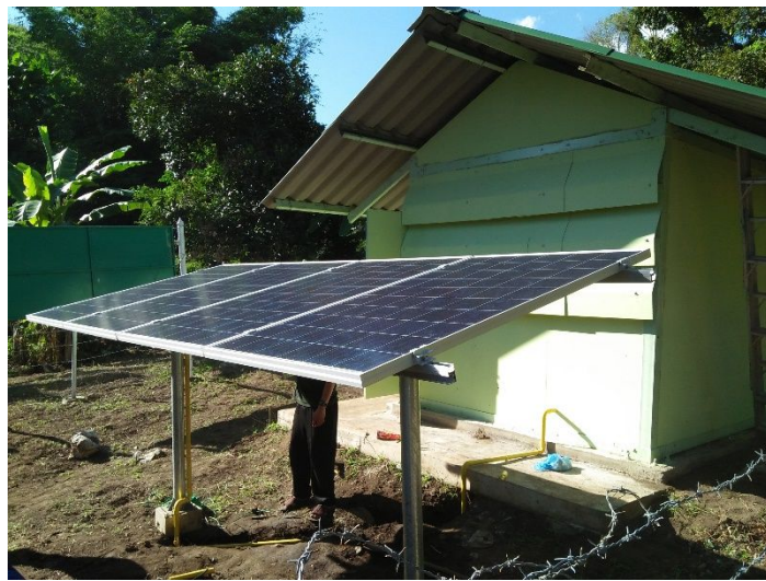
รูปที่ ก๖๔ แผงเซลล์แสงอาทิตย์ที่ติดตั้ง ณ ระบบฯ จุดที่ ๑๒
