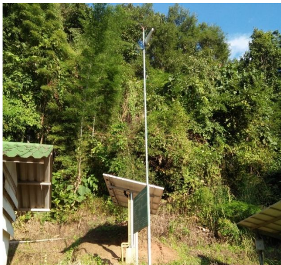
รูปที่ ๓๑๗ อุปกรณ์รับสัญญาณโทรศัพท์ที่ติดตั้ง ณ ระบบฯ จุดที่ ๒
