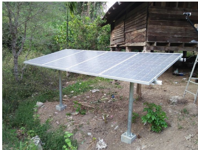
รูปที่ ๓๗๖ แผงเซลล์แสงอาทิตย์ที่ติดตั้ง ณ ระบบฯ จุดที่ ๑๕
