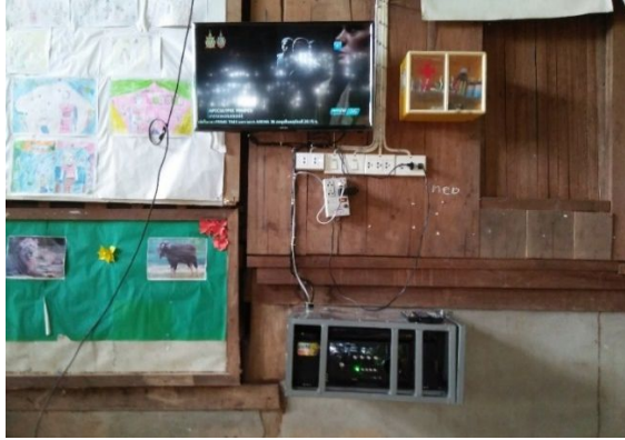
รูปที่ ก๑๘ อุปกรณ์ระบบการสื่อสารด้วยภาพและเสียงที่ติดตั้ง ณ ระบบฯ จุดที่ ๒
