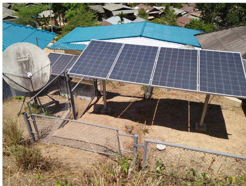
รูปที่ ก๓๑ แผงเซลล์แสงอาทิตย์ที่ติดตั้ง ณ ระบบฯ จุดที่ ๔
