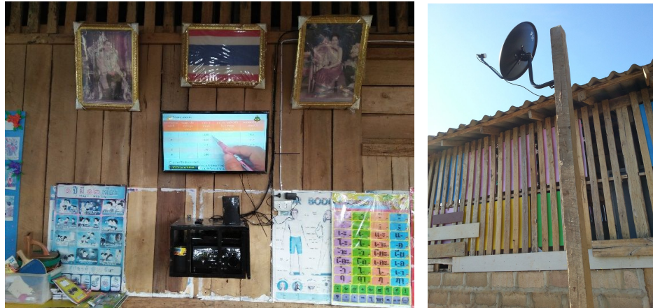
รูปที่ ก๕๘ อุปกรณ์ระบบการสื่อสารด้วยภาพและเสียงที่ติดตั้ง ณ ระบบฯ จุดที่ ๑๐
