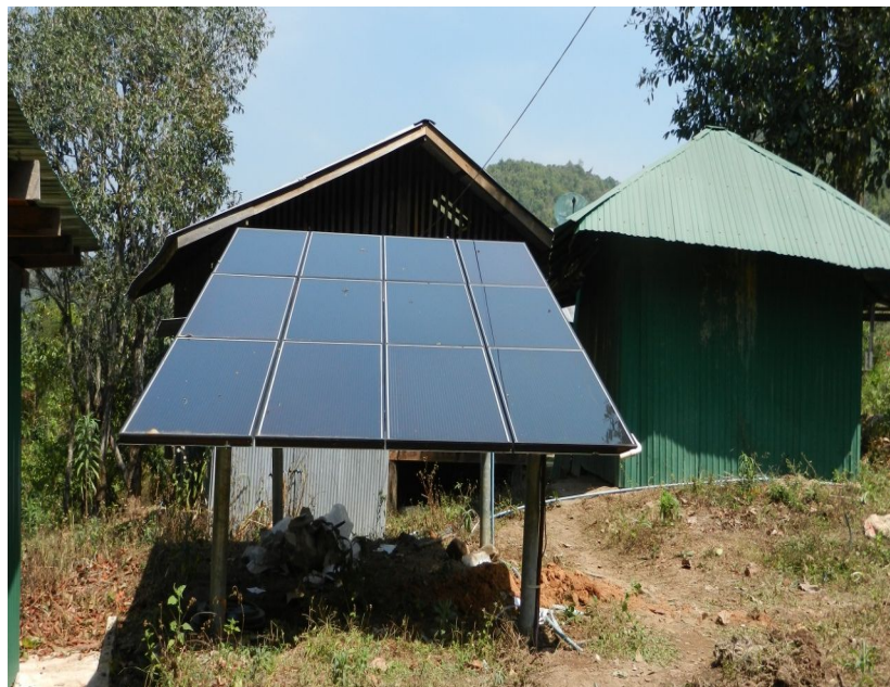
รูปที่ ๑๐ แผงเซลล์แสงอาทิตย์ที่ติดตั้ง ณ ศศช.บ้านห้วยเกียงน้อย อ.สบเมย จ.แม่ฮ่องสอน
