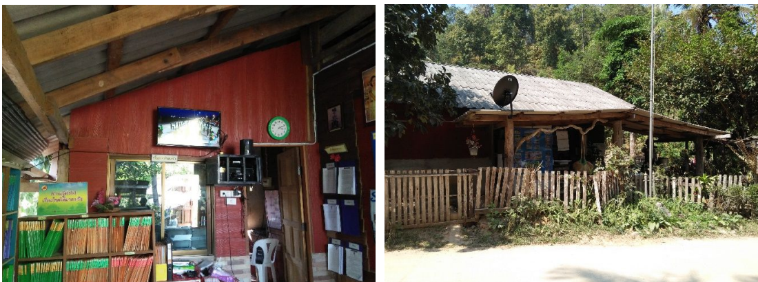
รูปที่ ก๔๒ อุปกรณ์ระบบการสื่อสารด้วยภาพและเสียงที่ติดตั้ง ณ ระบบฯ จุดที่ ๖
