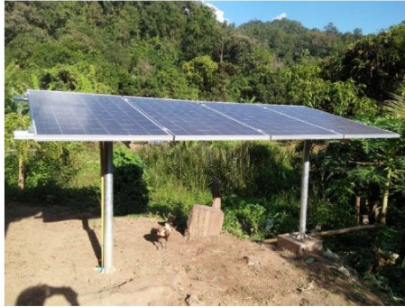
รูปที่ 4 ตัวอย่างการติดตั้งแผงเซลล์แสงอาทิตย์ ณ บ้านครูใหญ่ บ้านป่าสัก ระบบจุดที่ 1
