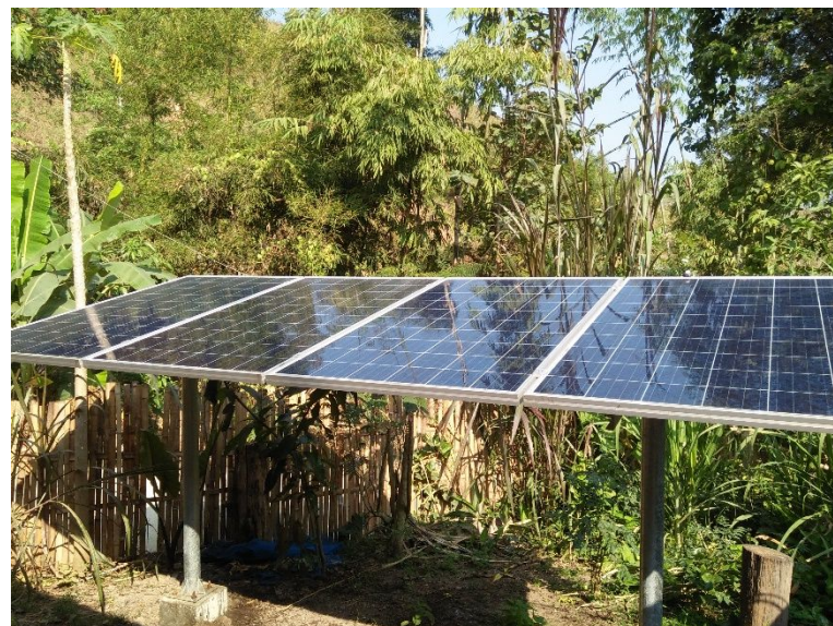
รูปที่ ๓๔๐ แผงเซลล์แสงอาทิตย์ที่ติดตั้ง ณ ระบบฯ จุดที่ ๖
