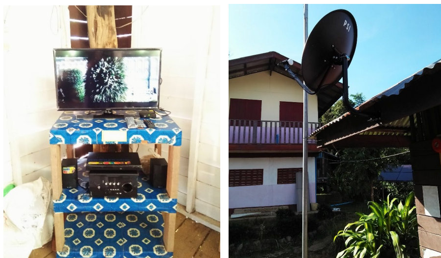
รูปที่ ๓๗๐ อุปกรณ์ระบบการสื่อสารด้วยภาพและเสียงที่ติดตั้ง ณ ระบบฯ จุดที่ ๑๓
