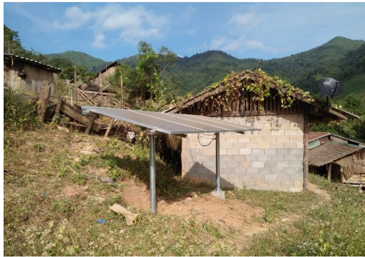
รูปที่ ก๖๐ แผงเซลล์แสงอาทิตย์ที่ติดตั้ง ณ ระบบฯ จุดที่ ๑๑
