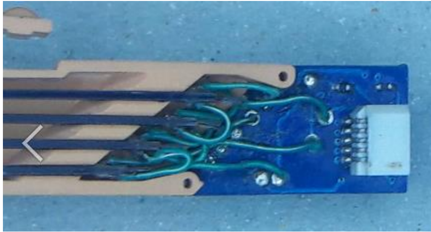
รูปที่ 4-3 ตัวอย่างการพันสายไฟฟ้าเพื่อเก็บให้เรียบร้อย
