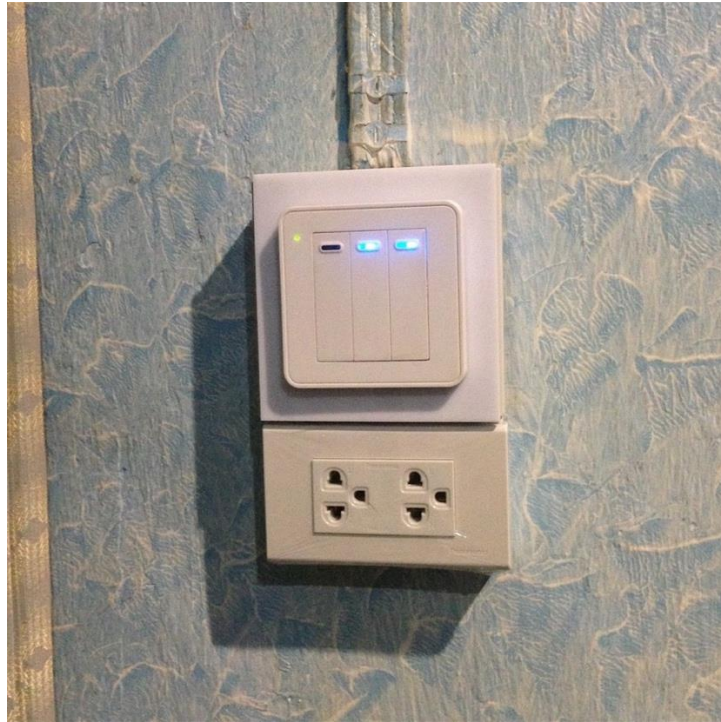
รูปที่ 47 สวิตซ์ที่ติดตั้งใหม่ บริเวณห้องนอนชั้น 2 ของบ้านคุณแม่อมรพรรณ จังหวัดภูเก็ต
