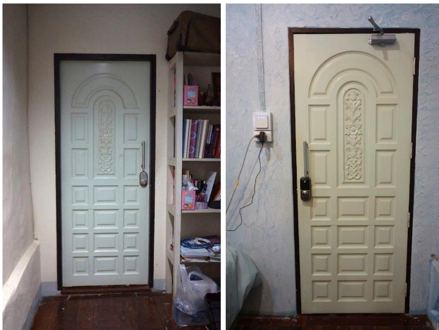
รูปที่ 59 ติดตั้ง Digital Door Lock ประตูห้องแม่ ของบ้านคุณแม่อมรพรรณ จังหวัดภูเก็ต
