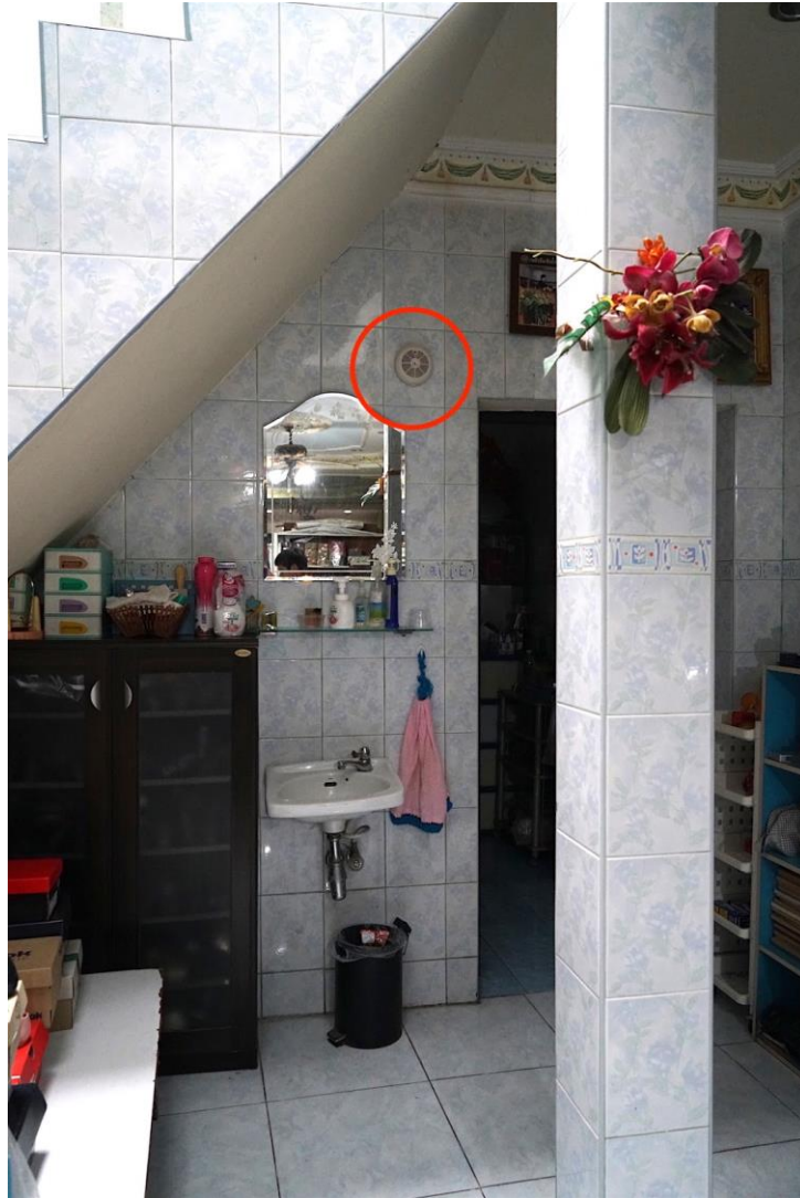
รูปที่ 53 Smoke Detector บริเวณใต้บันไดชั้น 1 ของบ้านคุณแม่อมรพรรณ จังหวัดภูเก็ต
