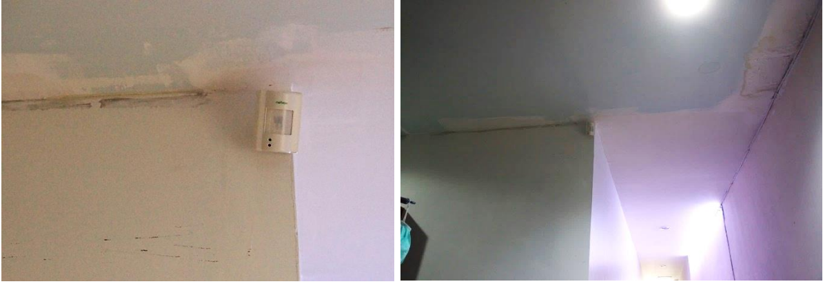
รูปที่ 54 เซนเซอร์ตรวจจับการเคลื่อนไหว บริเวณทางเดินชั้น 2 ของบ้านคุณแม่อมรพรรณ จังหวัดภูเก็ต
