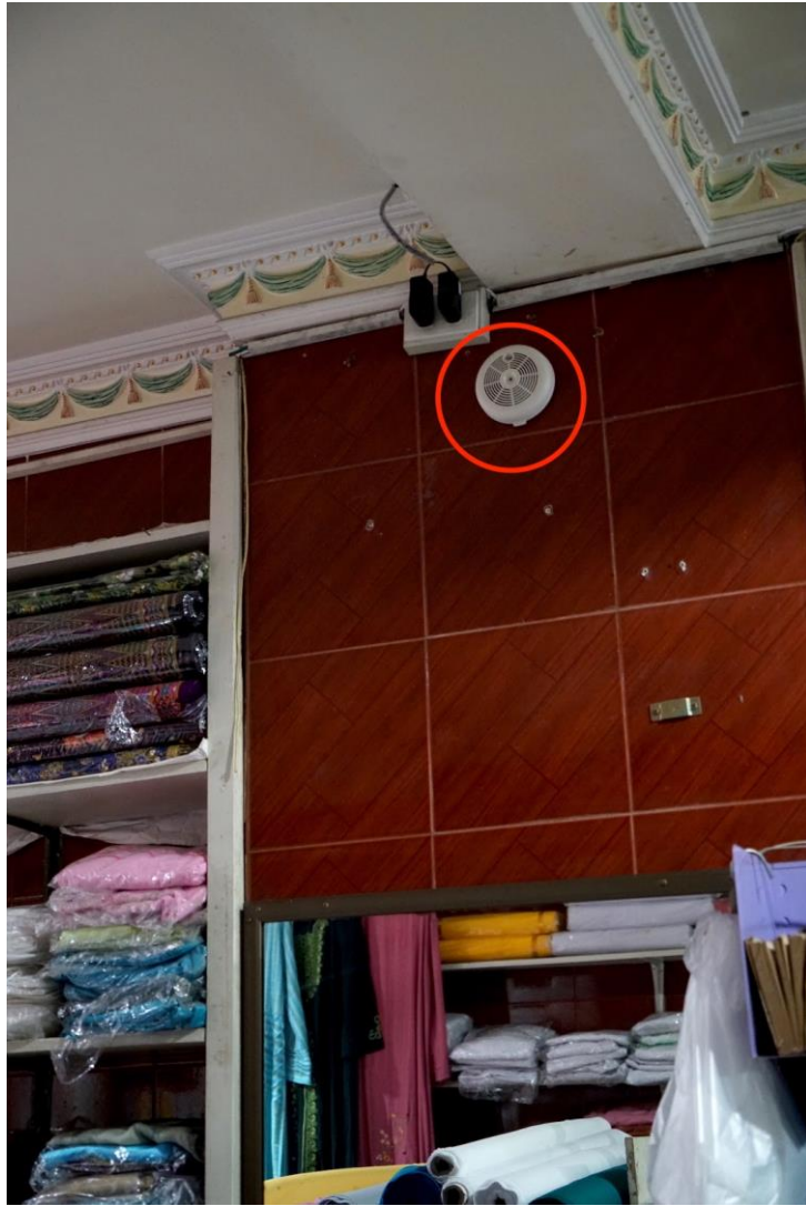
รูปที่ 52 Smoke Detector บริเวณชั้นวางขายผ้าชั้น 1 ของบ้านคุณแม่อมรพรรณ จังหวัดภูเก็ต
