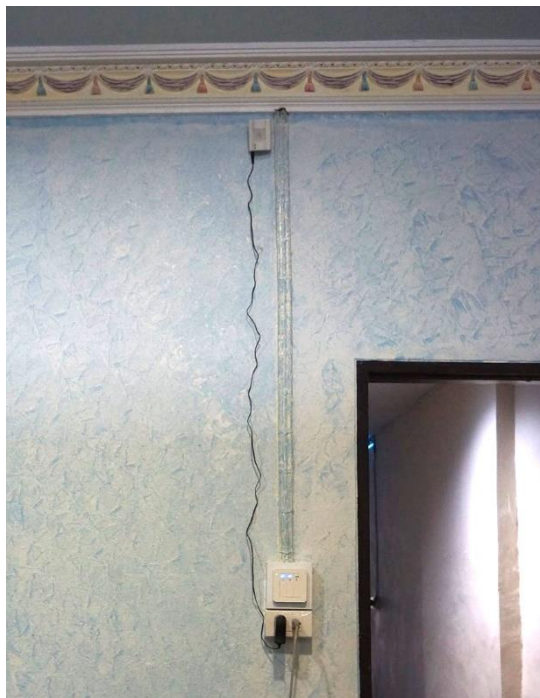
รูปที่ 55 เซนเซอร์ตรวจจับการเคลื่อนไหว บริเวณทางเดินชั้น 2 ของบ้านคุณแม่อมรพรรณ จังหวัดภูเก็ต
