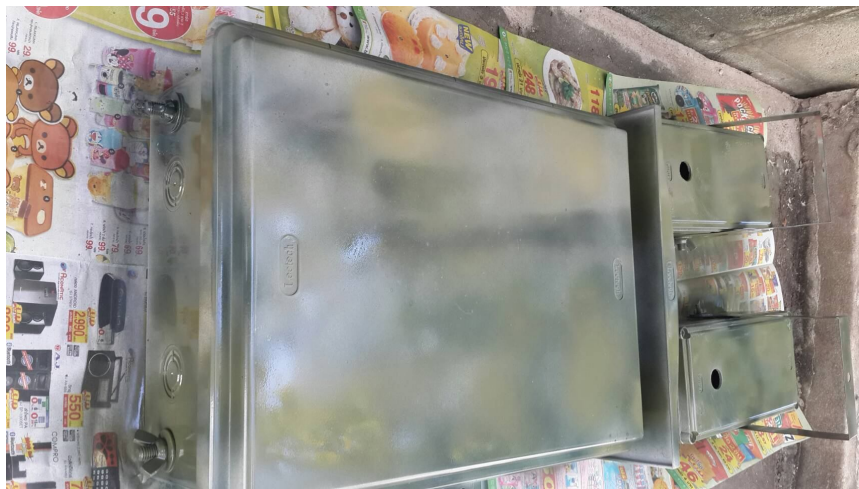
ภาพที่ 57 ตู้อุปกรณ์สำหรับระบบการตรวจจับภาพข้ามที่ผ่านการพ่นสีลายพราง
