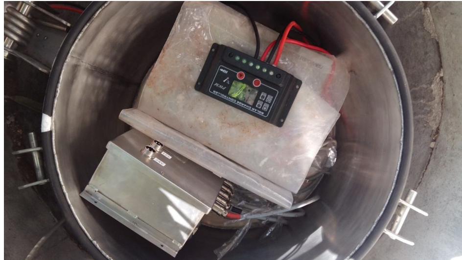
ภาพที่ 82 อุปกรณ์อิเล็กทรอนิกส์ในภาชนะกันน้ำในบ่อใต้ดิน
