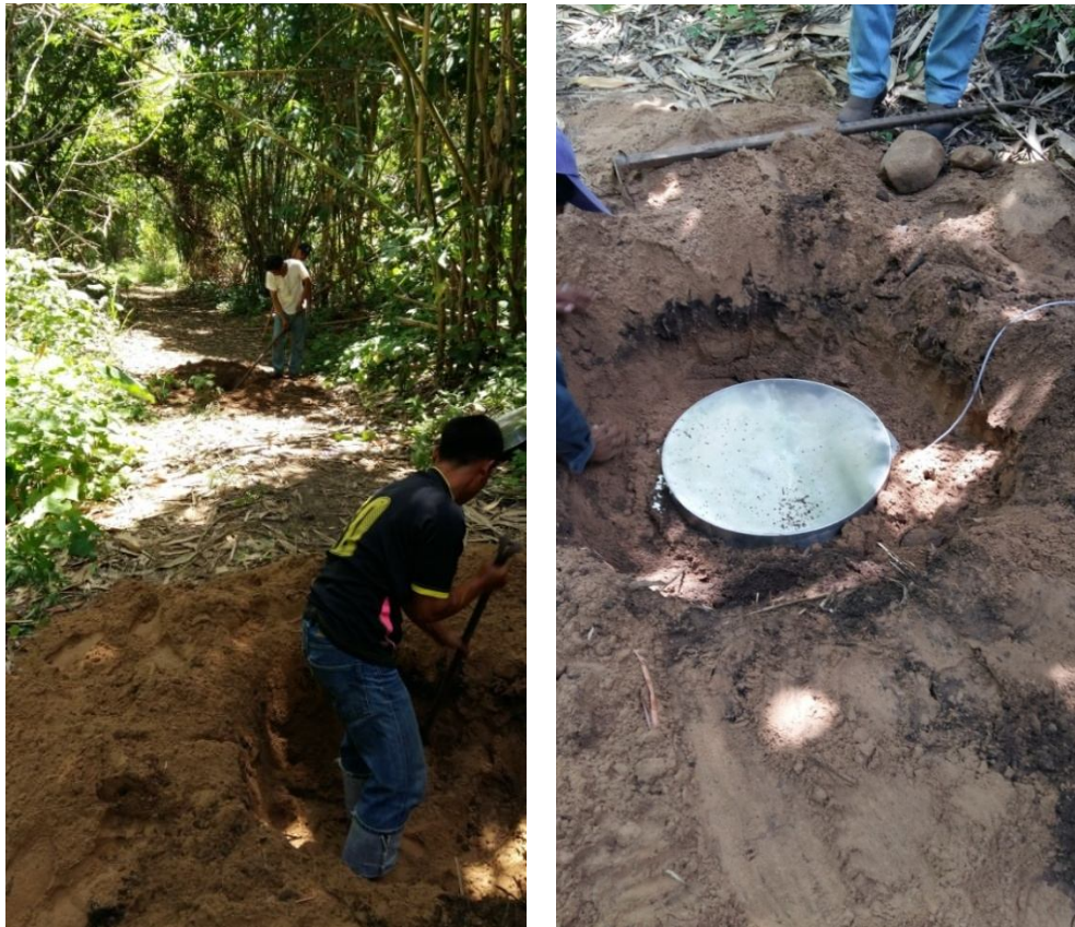
ภาพที่ 44 ชุดหลุมฝังอุปกรณ์ตรวจวัดความสั่นสะเทือน
