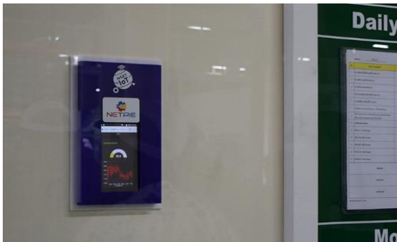
ระบบควบคุมอุณหภูมิในห้องตรวจสอบคุณภาพสินค้า
