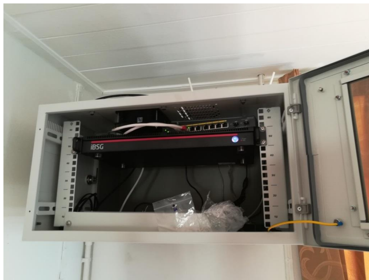
ภาพที่ 4.1.51 ภาพประกอบการติดตั้งอุปกรณ์ของระบบอินเทอร์เน็ต
