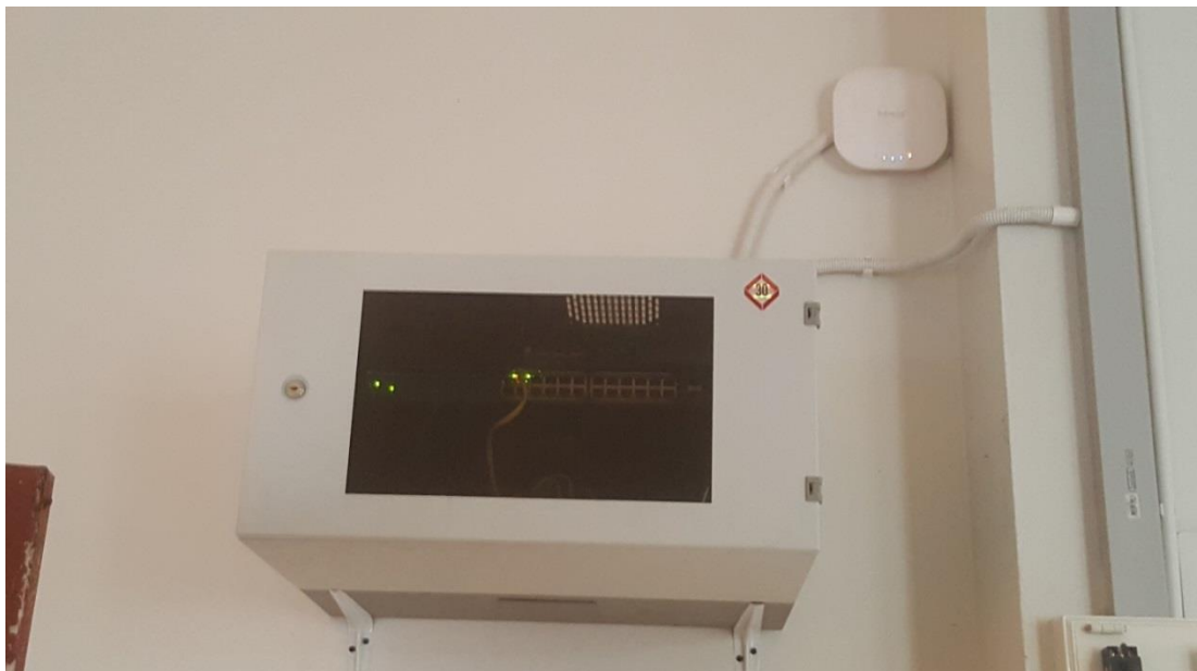
ภาพที่ 4.1.57 ภาพประกอบการติดตั้งอุปกรณ์ของระบบอินเทอร์เน็ต
