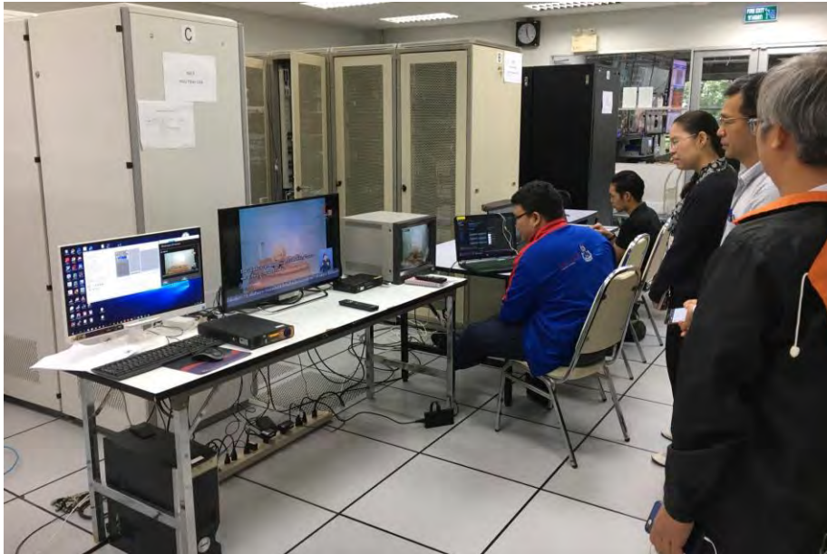
ภาพที่ 20 การติดตั้งอุปกรณ์เพื่อทดสอบออกอากาศบริการคำบรรยายแทนเสียงแบบเสมือนจริง
