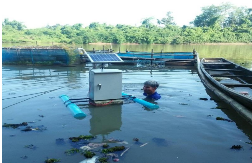
ภาพที่. 3-29 ตำแหน่งในการติดตั้งชุดตรวจวัดคุณภาพน้ำที่บ้านวังโพธิ์
