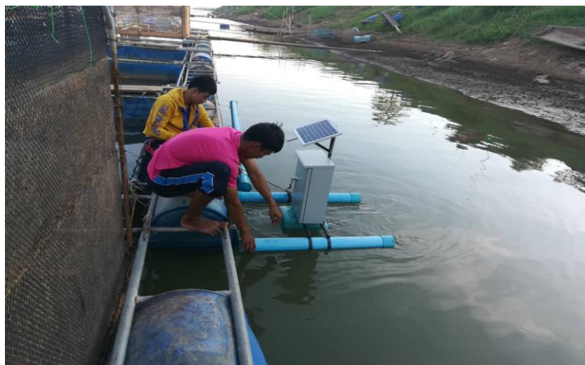
ภาพที่ 3-55 ตำแหน่งในการติดตั้งชุดตรวจวัดคุณภาพน้ำที่บ้านหลักศิลา
