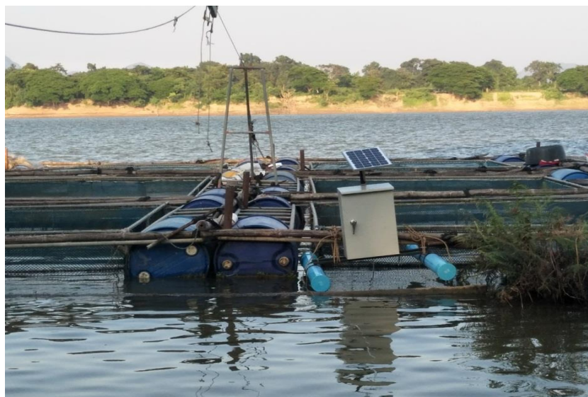
ภาพที่ 3-47 นำไปติดตั้งของชุดตรวจวัดคุณภาพน้ำที่บ้านห่อม
