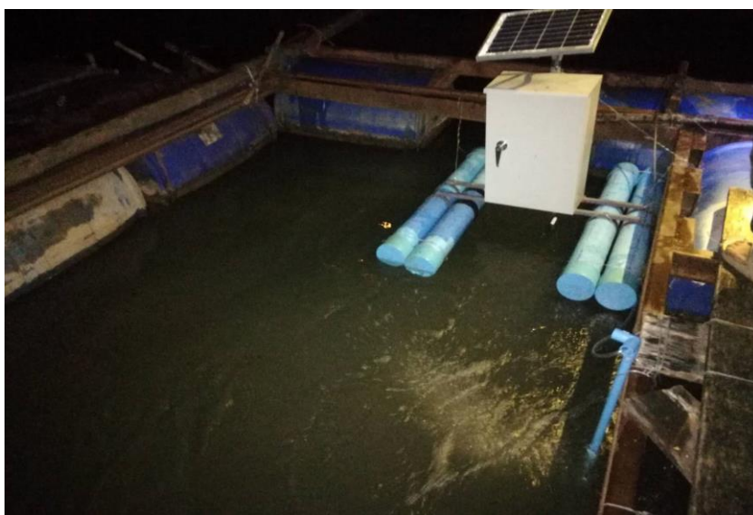
ภาพที่ 3-63 ตำแหน่งในการติดตั้งชุดตรวจวัดคุณภาพน้ำที่ชุมชนวัดทุ่งประชานารถ
