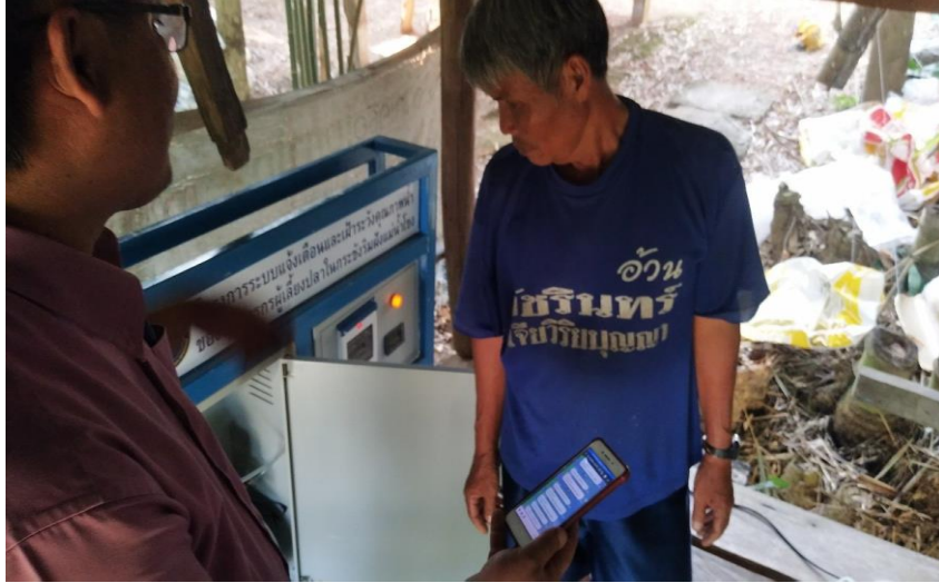
ภาพที่.3-26 ผลการทดสอบการควบคุมมาสั่งการให้ชุดเติมอากาศทำงานผ่านรีโมตจากชุด ตรวจวัดคุณภาพน้ำ
