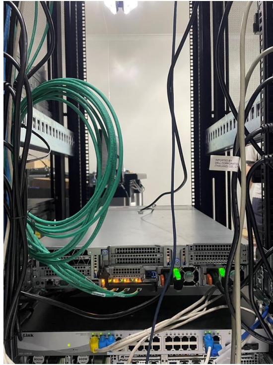
รูปที่ 52 ภาพด้านหลังของเครื่องคอมพิวเตอร์แม่ข่าย พร้อมสายไฟและสายอินเทอร์เน็ต
