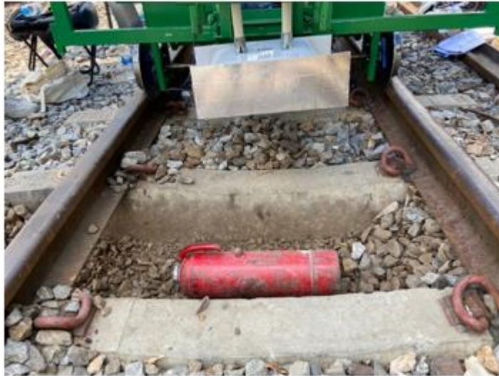
รูปที่ 126 การวางถังดับเพลิงไว้ในหลุม ในรางรถไฟที่ยังไม่มีการฝังกลบ
