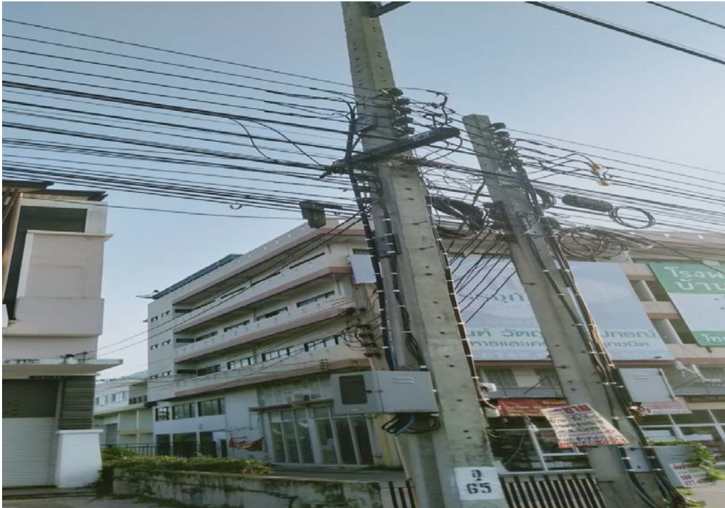
รูปที่ 85 สายสื่อสารพาดติดเสาไฟฟ้าก่ดทับสายไฟฟ้าแรงต่ำทำให้เกิดไฟฟ้ารั่ว
