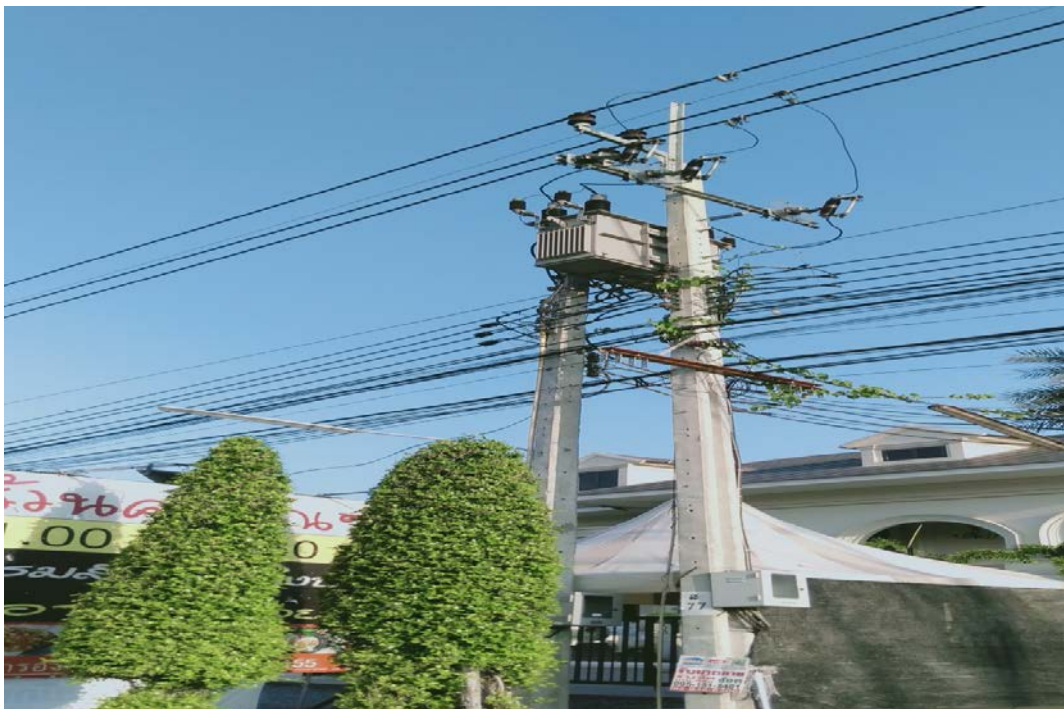
รูปที่ 86 สายสื่อสารยึดกับเสาไฟฟ้าในระดับที่สูงกว่าสายไฟฟ้าแรงต่ำทำให้พนักงานจัดระเบียบสายสื่อสารไม่สามารถรื้อถอนสายสื่อสารเพื่อจัดระเบียบสายจับยึดใส่ในเควิตได้
