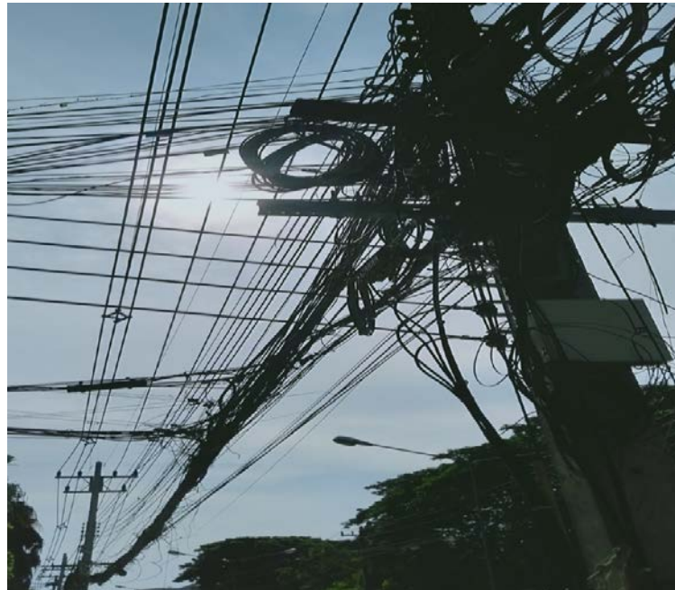
รูปที่ 83 สายสื่อสารที่ระยะหย่อนยานต่ำกว่ามาตรฐาน อาจถูกรถบรรทุกเกี่ยวตึงสายสื่อสารได้
