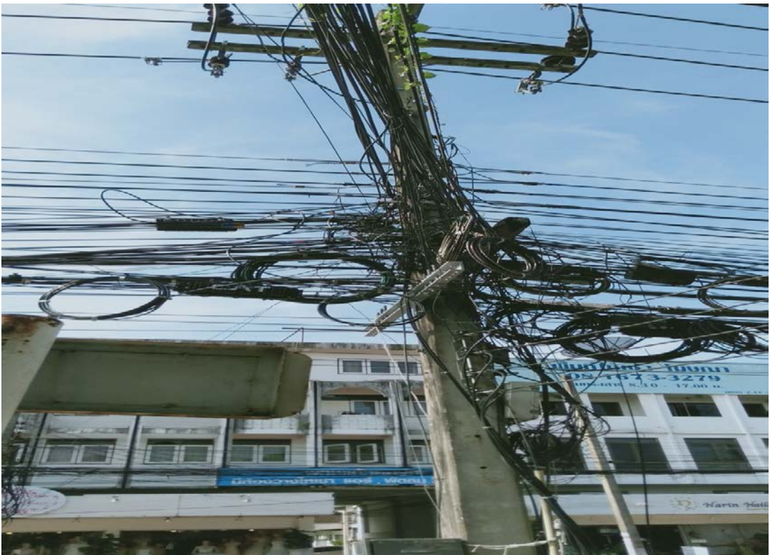
รูปที่ 82 สายสื่อสารติดตั้งกับเสาไฟฟ้าจำนวนมาก และยังมีลูบอีกจำนวนมาก
