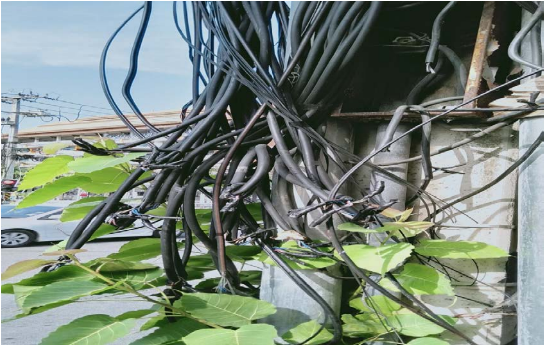
รูปที่ 81 สายสื่อสารยึดกับเสาไฟฟ้า มีสายไฟฟ้าที่ถูกตัดและพันเทปไว้ แต่ไฟฟ้าไม่สามารถรื้อถอนได้
