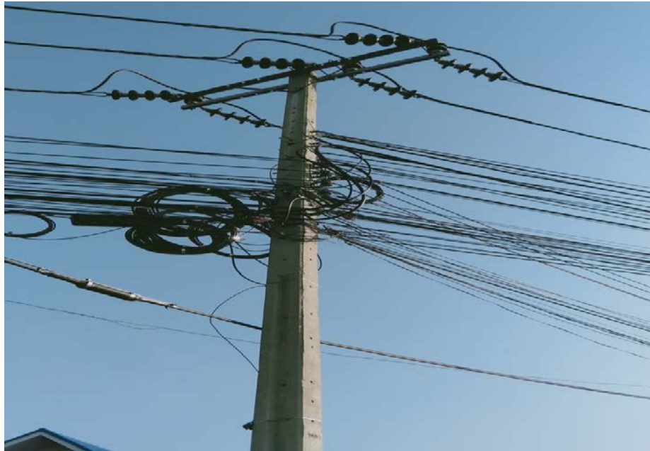
รูปที่ 87 สายสื่อสารติดตั้งกับเสาไฟฟ้าจำนวนมาก และมีลูบอีกจำนวนมาก เป็นอันตรายเพราะสายสื่อสารปะปนกับสายแรงดันต่ำ
