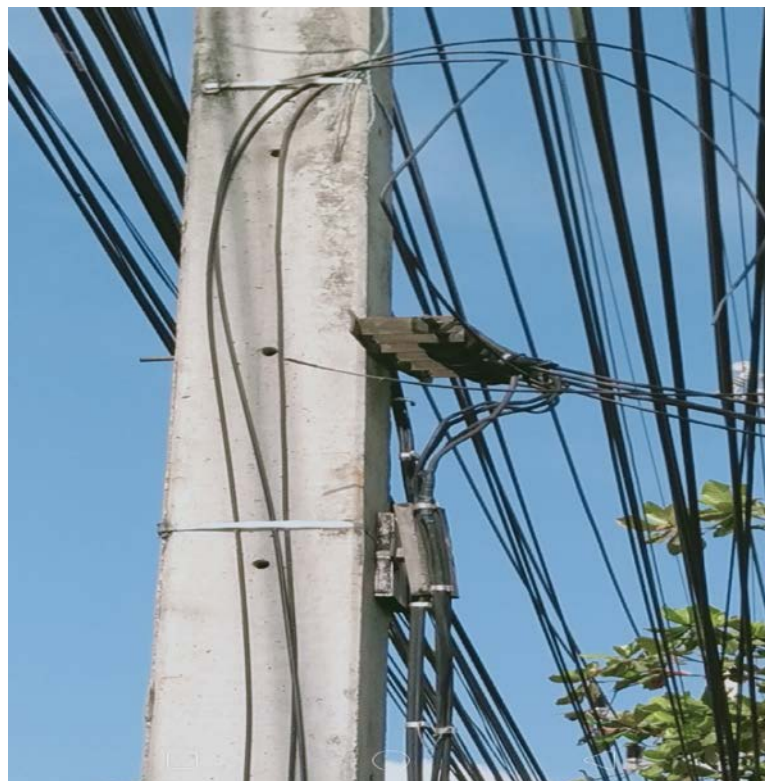
รูปที่ 84 เร็คไฟแรงต่ำชำรุดเสียหาย และมีการลักลอบนำสายสื่อสารพาดผ่านอยู่ในเร็คไฟแรงต่ำ
