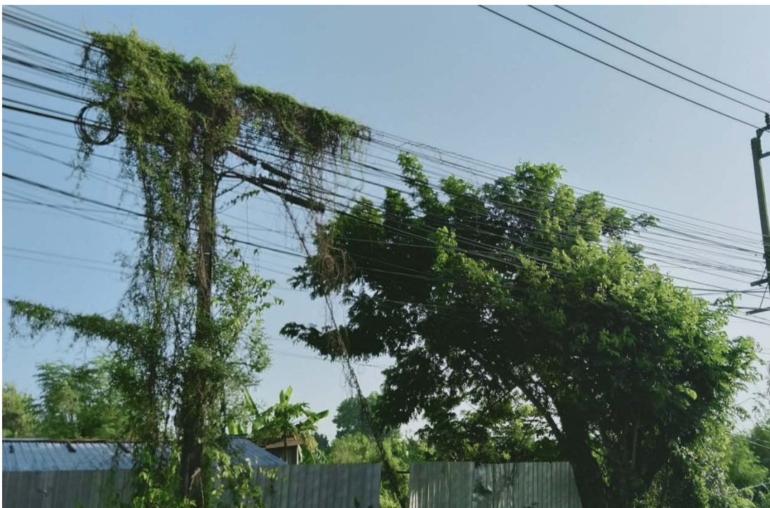
รูปที่ 88 สายสื่อสารพาดสายระหว่างกลางของสายไฟฟ้าแรงสูง ซึ่งเป็นอุปกรณ์ Drop out
