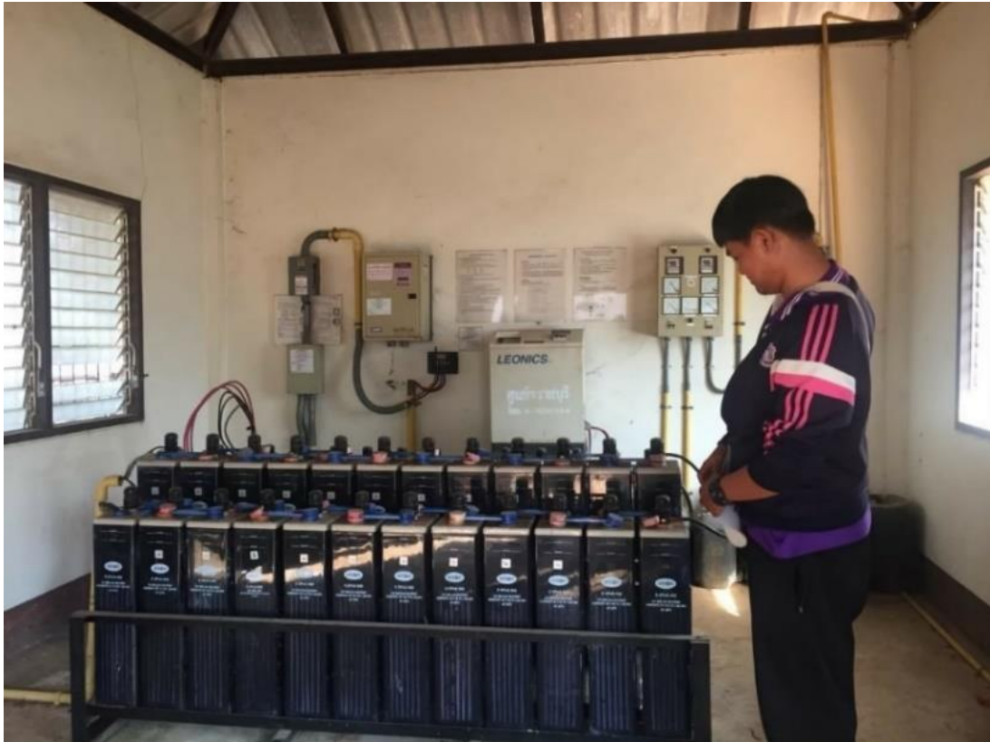
ภาพที่ ๔ ห้องเก็บแบตเตอรี่สำรองไฟ
