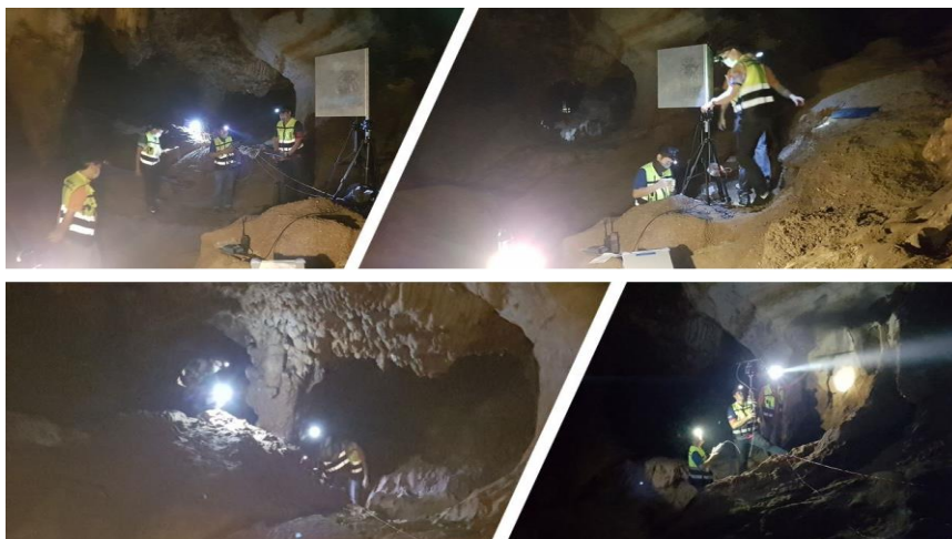
รูปที่ 12 แสดงภาพการติดตั้งอุปกรณ์และเครื่องมือสำหรับการวัดทดสอบแบบ LOS ย่านความถี่ UHF ภายในถ้ำเชียงดาว อ.เชียงดาว จ.เชียงใหม่
