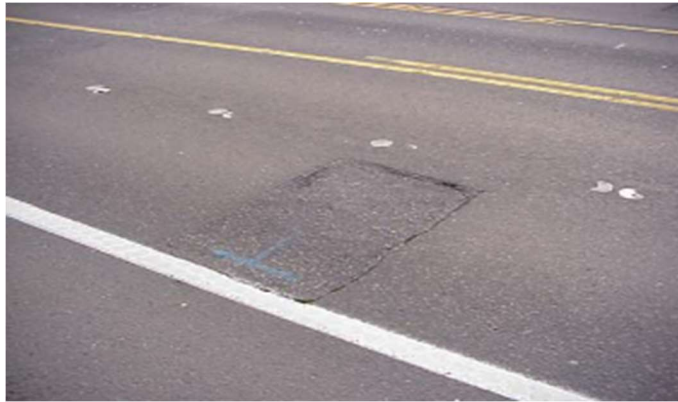
ภาพที่ 2-17 ตัวอย่างความเสียหายชนิดรอยปะซ่อม (Patching)
