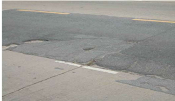
ภาพที่ 2-22 ตัวอย่างความเสียหายชนิดรอยปะซ่อมผิวคอนกรีต (Concrete Pavement Patching)
