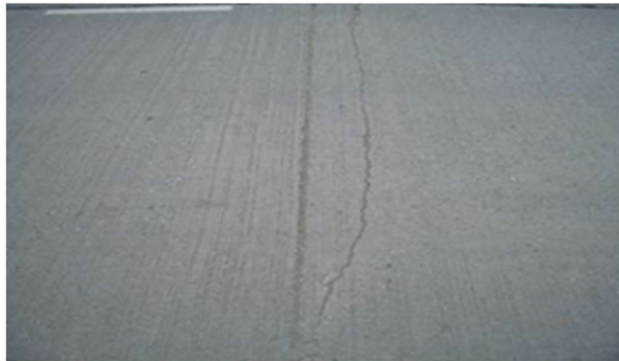
ภาพที่ 2-11 ตัวอย่างความเสียหายของระบบถ่ายน้ำหนักบริเวณรอยต่อ (Joint Load Transfer System Deterioration)
