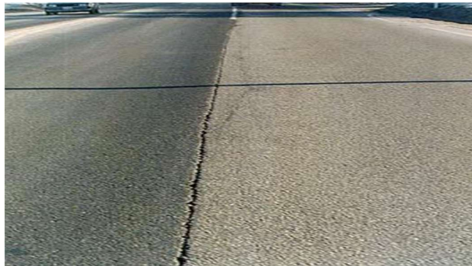
ภาพที่ 2-5 ตัวอย่างความเสียหายชนิดรอยแตกระหว่างช่องจราจร (Lane Joint Crack)
