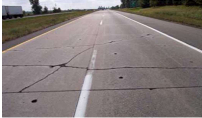
ภาพที่ 2-10 ตัวอย่างความเสียหายชนิดแผ่นพื้นถูกแบ่งแยก (Divided Slab)
