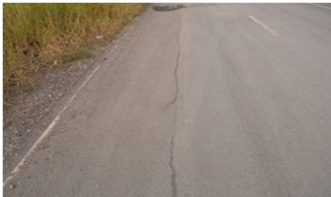
ภาพที่ 2-6 ตัวอย่างความเสียหายชนิดรอยแตกการขยายคันทาง (Widening Crack)
