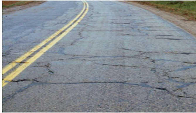
ภาพที่ 2-3 ตัวอย่างความเสียหายบนผิวทางจราจรชนิดรอยแตกเป็นตารางหรือรอยแตกจากการหดตัว (Block Crack or Shrinkage Crack)
