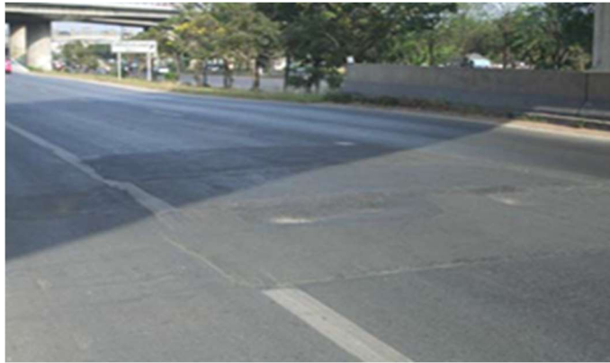
ภาพที่ 2-16 ตัวอย่างความเสียหายชนิดการทรุดตัวของผิวจราจร (Utility Cut Depression)
