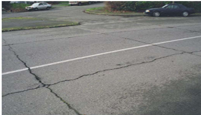
ภาพที่ 2-4 ตัวอย่างความเสียหายบนผิวทางจราจรชนิดรอยแตกสะท้อน (Reflection Crack)
