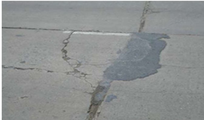
ภาพที่ 2-9 ตัวอย่างความเสียหายชนิดรอยแตกที่มุม (Corner Crack)
