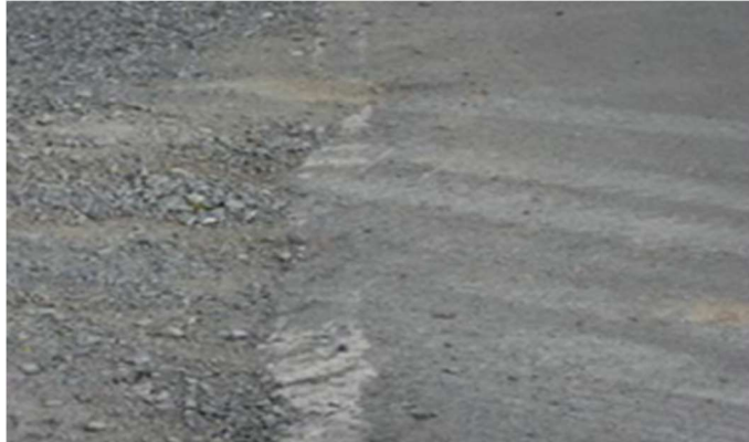
ภาพที่ 2-23 ตัวอย่างความเสียหายชนิดความเสียหายตามขอบ (Edge Deterioration)
