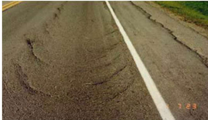
ภาพที่ 2-21 ตัวอย่างความเสียหายชนิดการปูดนูน (Shoving)
