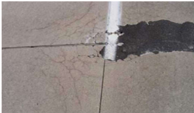
ภาพที่ 2-12 ตัวอย่างความเสียหายชนิดรอยแตกจากคอนกรีตสูญเสียความทนทาน (Durability “D” Crack)
