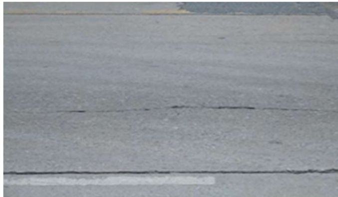
ภาพที่ 2-7 ตัวอย่างความเสียหายชนิดรอยแตกตามยาว (Longitudinal Crack)
