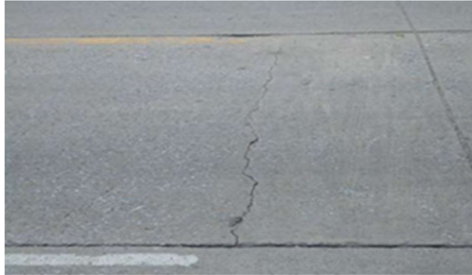
ภาพที่ 2-8 ตัวอย่างความเสียหายชนิดรอยแตกตามขวางและรอยแตกตามแนวทแยงมุม (Transverse Crack and Diagonal Crack)
