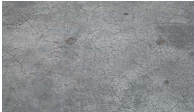
ภาพที่ 2-1 ตัวอย่างความเสียหายบนผิวทางจราจรชนิดผิวแตกลายงาหรือผิวแตกร้าว (Map Cracking or Cracking)
