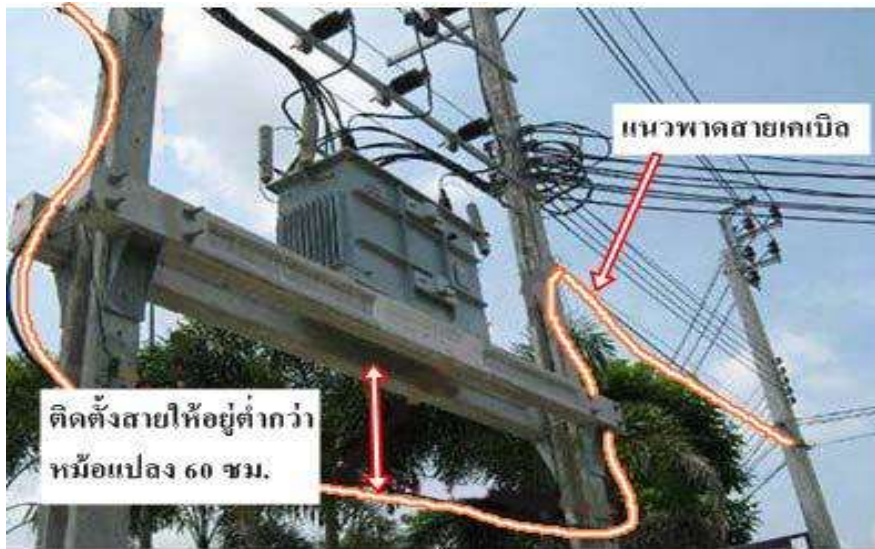
รูปแสดงการพาดสายเคเบิลผ่านหม้อแปลงไฟฟ้า
