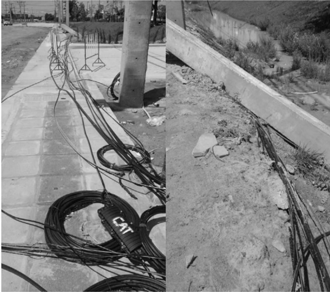
ภาพการร้อยถนนเสาไฟฟ้าเพื่อขยายถนน ทำให้ต้องปลดสายเคเบิลใยแก้วลงมาวางกับพื้น ซึ่งจะทำให้เกิดความเสียหายกับสายเคเบิลฯ
