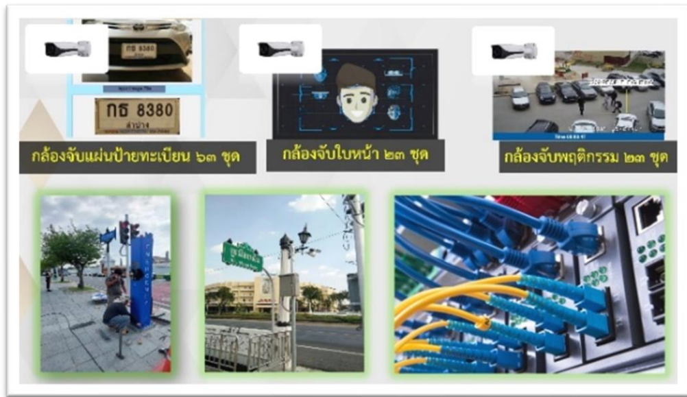
รูปที่ 3.5 ระบบกล้องโทรทัศน์วงจรปิด (CCTV) และเสาแจ้งเหตุ
