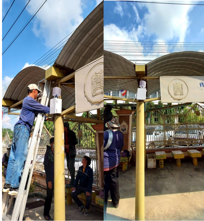
ภาพที่ 57 การติดตั้งเครื่องวัดฝุ่นละอองขนาดเล็ก (PM2.5) บริเวณจุดรอรถขนส่งสาธารณะหน้าโรงพยาบาลพุทธชินราช
