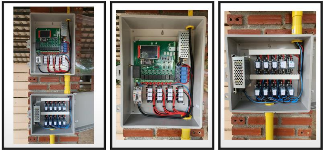
รูปที่ ๔.๑๔ Controller Module ของระบบการให้น้ำและ Microclimate Monitoring ในแปลงปลูก
