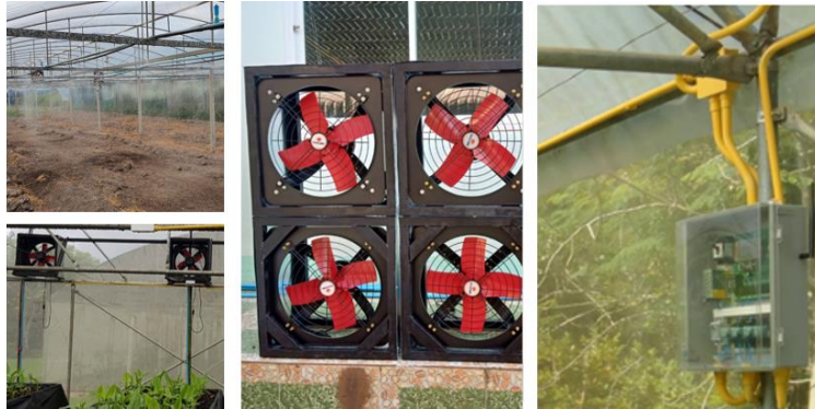
รูปที่ ๕ ระบบระบายความร้อนในโรงเรือนด้วยพัดลมและระบบพ่นหมอก
