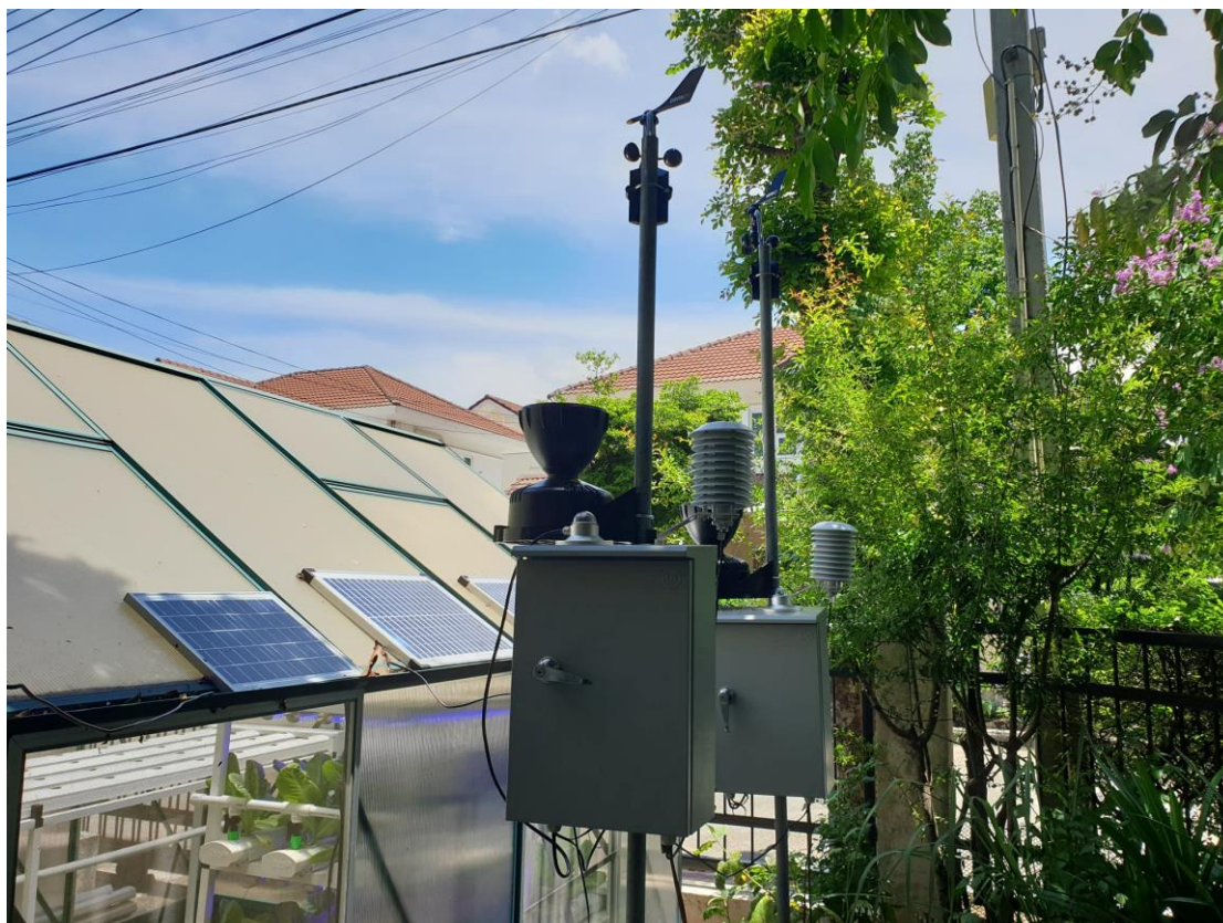
ภาพที่ 98 แสดงสถานีตรวจวัดสภาพแวดล้อมจริงสำหรับที่จะนำไปติดตั้งในไร่กาแพ
