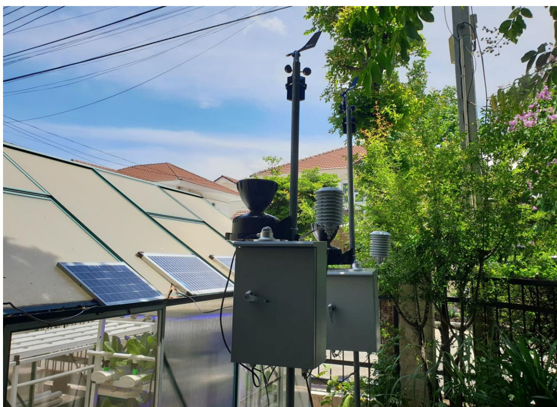
ภาพที่ 86 แสดงสถานีตรวจวัดสภาพแวดล้อมจริงสำหรับที่จะนำไปติดตั้งในไร้กาแพ
