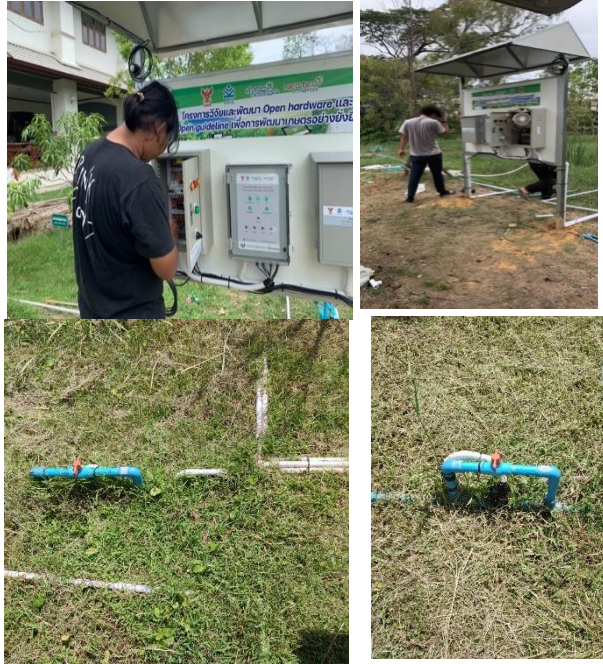
ภาพที่ ๓๕ แสดงการปฏิบัติงานขณะทำการติดตั้งระบบเกษตรอัจฉริยะ ณ สวนมะม่วงพื้นที่เปิดโล่ง แปลงอนุรักษ์สายพันธุ์มะม่วง จังหวัดฉะเชิงเทรา
