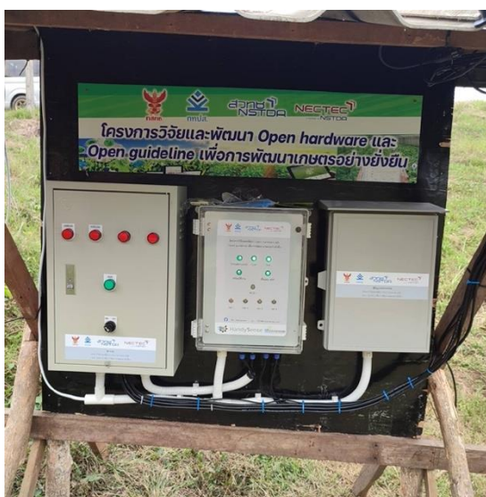
ภาพที่ ๕๗ แสดงสถานีติดตั้งระบบเกษตรอัจฉริยะของสวนกำนันสาคร สวนทุเรียนพื้นที่เปิดโล่ง
