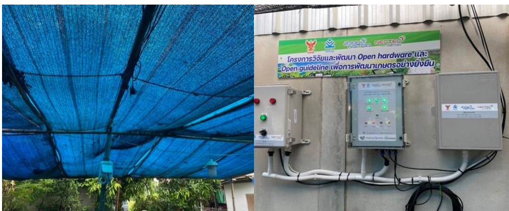
ภาพที่ ๔๙ แสดงจุดติดตั้งระบบเกษตรอัจฉริยะและอุปกรณ์ตรวจรู้ของอรรคิราห์ฟาร์ม
