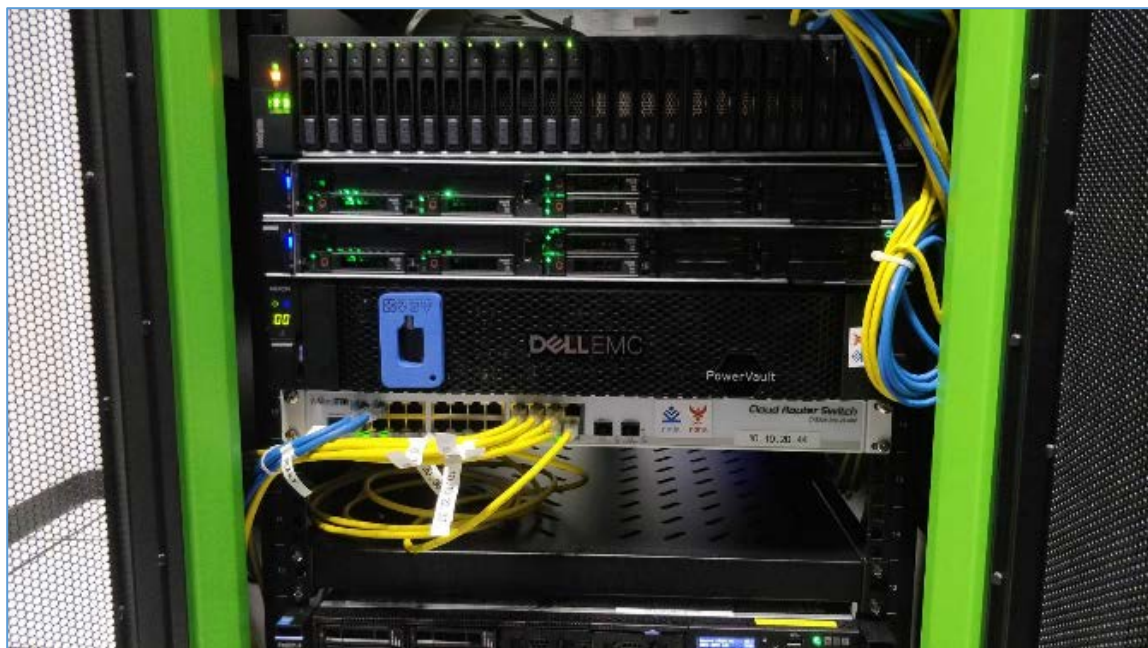
ภาพที่ 5-8 แสดงการติดตั้งเครื่องคอมพิวเตอร์แม่ข่าย ณ ห้องดาต้าเซ็นเตอร์ ของบริษัท อินเทอร์เน็ตประเทศไทย จำกัด (มหาชน)
