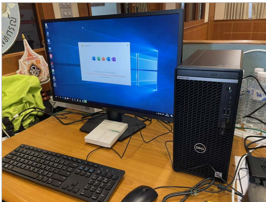
ภาพที่ 5-6 แสดงการติดตั้งเครื่องคอมพิวเตอร์และอุปกรณ์ที่ห้องฝึกอบรม อาคาร 4 ชั้น 4
