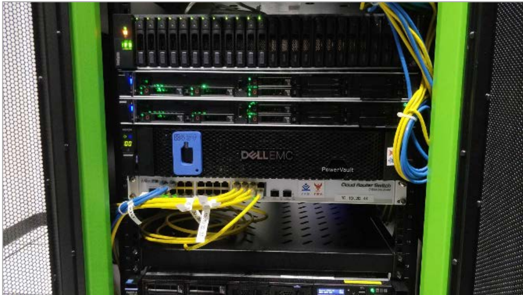
ภาพที่ 5-19 แสดงการติดตั้งเครื่องคอมพิวเตอร์แม่ข่าย และอุปกรณ์สำหรับจัดเก็บข้อมูลแบบภายนอก
