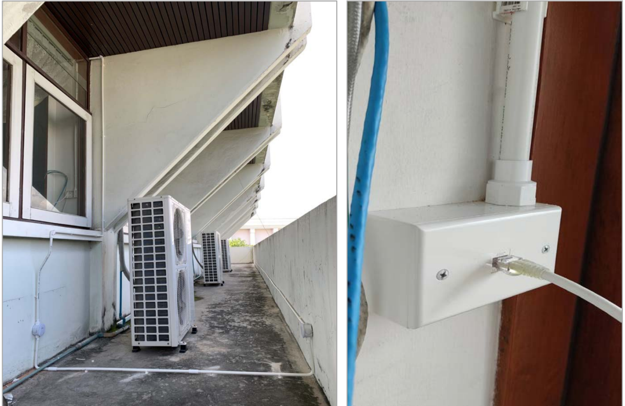
ภาพที่ 5-3 แสดงจุดการติดตั้งสัญญาณอินเทอร์เน็ต ณ ห้องฝึกอบรม อาคาร 4 ชั้น 4
