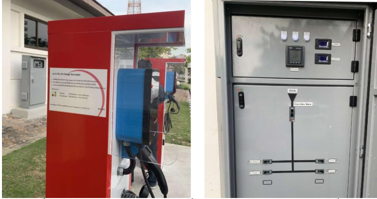
รูปที่ 1-11 การติดตั้งป้ายและวิธีใช้งาน พร้อมทั้ง emergency contact ทั้งที่บริเวณ charger และบริเวณตู้ EVDB
