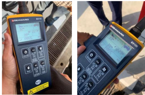
รูปที่ 1-10 การทดสอบเครื่อง charger ด้วย EV Tester สำหรับเครื่องทั้งสองตัว สถานะ ผ่าน ทั้งสองตัว
