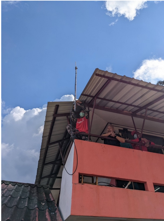
ก. อุปกรณ์โลล่าเกตเวย์ติดตั้งไว้ที่ รร.ป่า ชางนาเงิน
