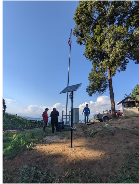
ข. อุปกรณ์เซ็นเซอร์พร้อมด้วยแผงโซลาร์ เซลล์ ติดตั้งไว้ที่ฐานปฏิบัติการน้ำปิง
