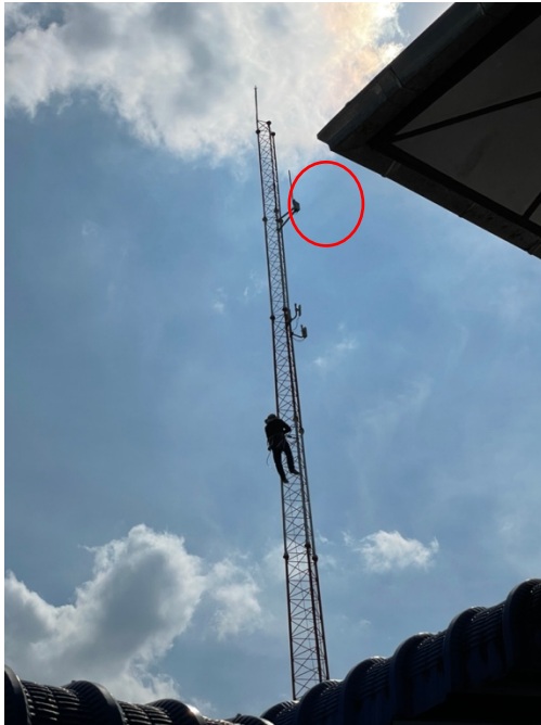
รูปที่ 69 การติดตั้งอุปกรณ์โลล่าเกตเวย์ ที่ อำเภอแม่สอด จังหวัดตาก
