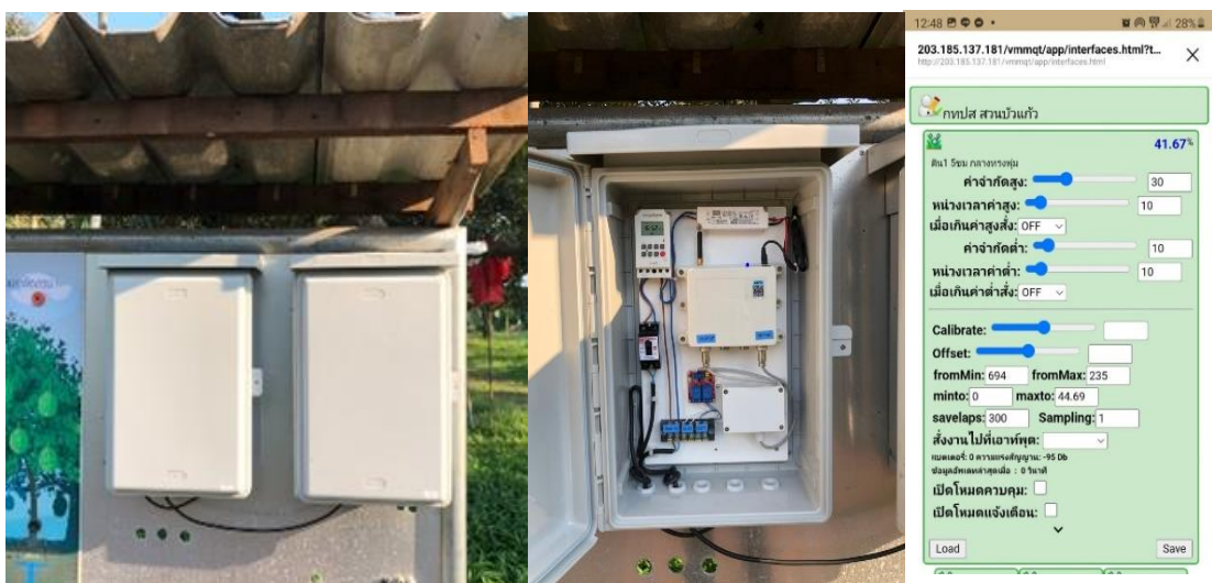
ภาพที่ 10 จุดติดตั้งอุปกรณ์อ่านค่า/ส่งข้อมูลสำหรับเชื่อมต่อเซ็นเซอร์
