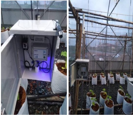
ภาพที่ 55 Wireless module วัดความเข้มแสง อุณหภูมิ ความชื้นอากาศ
