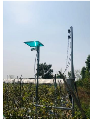
ภาพที่ 41 ระบบไฟฟ้าไปยังตำแหน่งที่ติดตั้ง อุปกรณ์ภายในแปลง ประกอบด้วย ตำแหน่ง ติดตั้งเซ็นเซอร์ และกล้องวงจรปิด CCTV
