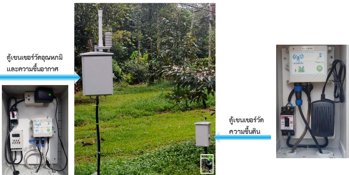
ภาพที่ 5 อุปกรณ์ตู้ควบคุมปั๊มน้ำ ตู้รับส่งสัญญาณ ตู้เซนเซอร์วัดอุณหภูมิและความชื้นอากาศ ตู้เซนเซอร์วัดความชื้นดินและตู้ Router
