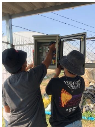
ภาพที่ 42 วงจรควบคุมปั้มน้ำ จำนวน 1 ชุด ควบคุมปั้มน้ำขนาด 2 แรงม้า ไฟฟ้า 220v
