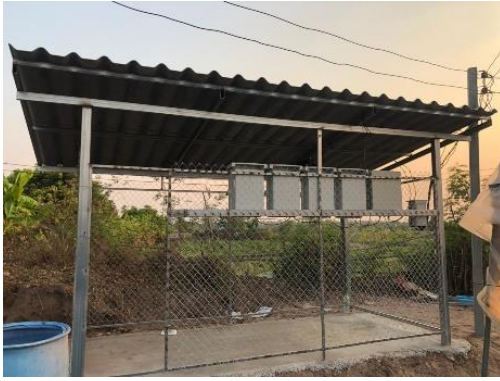
ภาพที่ 40 จุดติดตั้งอุปกรณ์อ่านค่า/ส่งข้อมูล สำหรับเชื่อมต่อเซ็นเซอร์ และอุปกรณ์รับ-ส่ง สัญญาณภาพกล้อง CCTV
