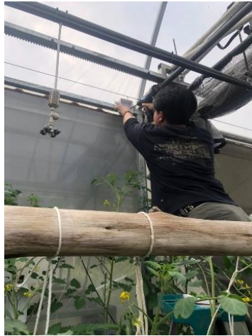
ภาพที่ 30 ระบบไฟฟ้าไปยังตำแหน่งที่ติดตั้งเซ็นเซอร์ และกล้องวงจรปิด CCTV
