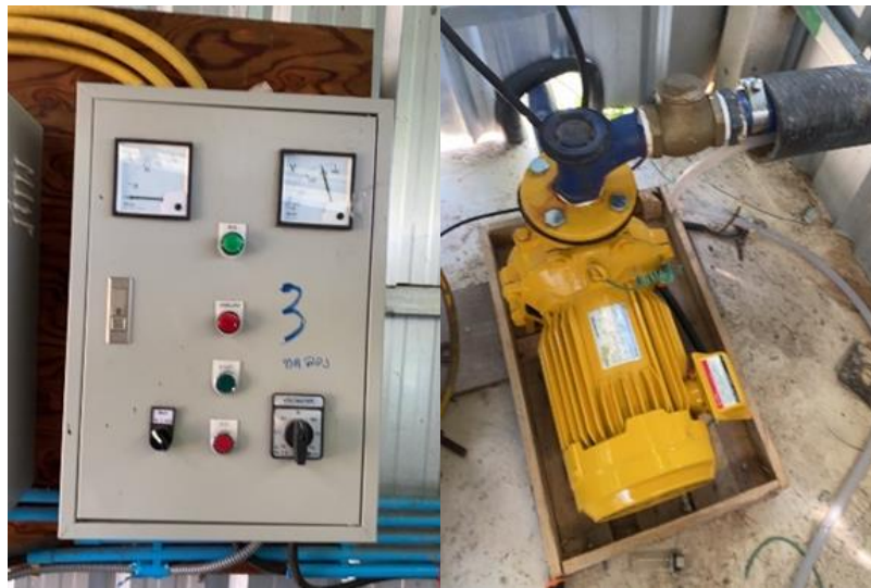
ภาพที่ 9 วงจรควบคุมปั้มน้ำ จำนวน 1 ชุด ควบคุมปั้มน้ำขนาด 2 แรงม้า ไฟฟ้า 220V
