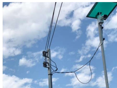
ภาพที่ 19 ระบบไฟฟ้าไปยังตำแหน่งที่ติดตั้ง อุปกรณ์ภายในแปลง ประกอบด้วย ตำแหน่ง ติดตั้งเซ็นเซอร์ และกล้องวงจรปิด CCTV
