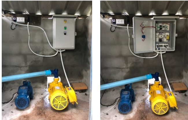
ภาพที่ 20 วงจรควบคุมปั้มน้ำ จำนวน 1 ชุด ควบคุมปั้มน้ำขนาด 2 แรงม้า ไฟฟ้า 220v
