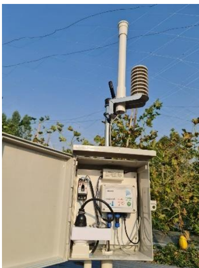
ภาพที่ 45 Wireless module วัดความเข้มแสง อุณหภูมิ ความชื้นอากาศ
