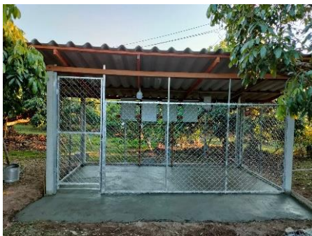
ภาพที่ 18 จุดติดตั้งอุปกรณ์อ่านค่า/ส่งข้อมูล สำหรับเชื่อมต่อเซ็นเซอร์ และอุปกรณ์รับ-ส่ง สัญญาณภาพกล้อง CCTV
