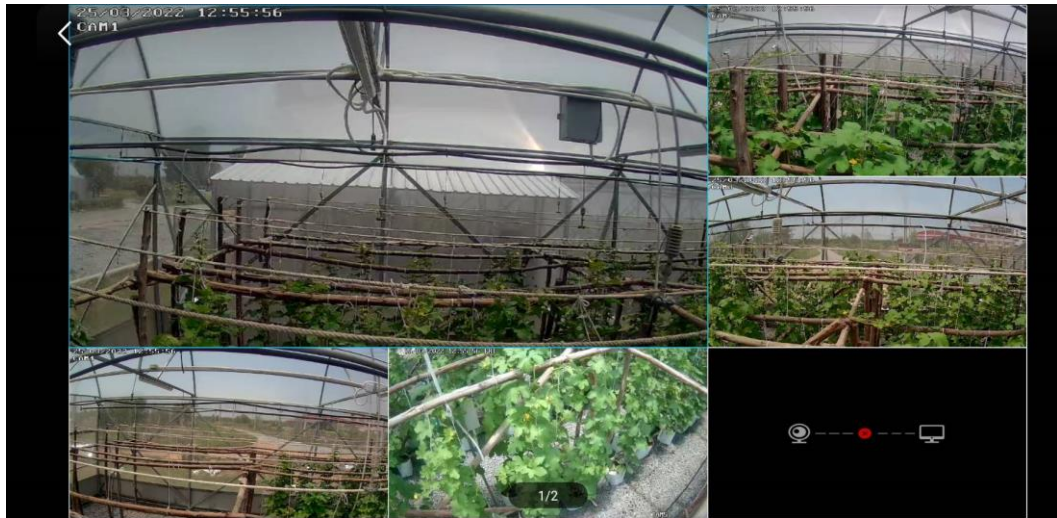
ภาพที่ 57 การติดตั้งกล้องวงจรปิด CCTV ณ โรงเรือนปลูกเมลอนผลสด สถาบันวิจัยและพัฒนา มหาวิทยาลัยสวนดุสิต จังหวัดสุพรรณบุรี และภาพการทำงานของกล้องวงจรปิด CCTV
