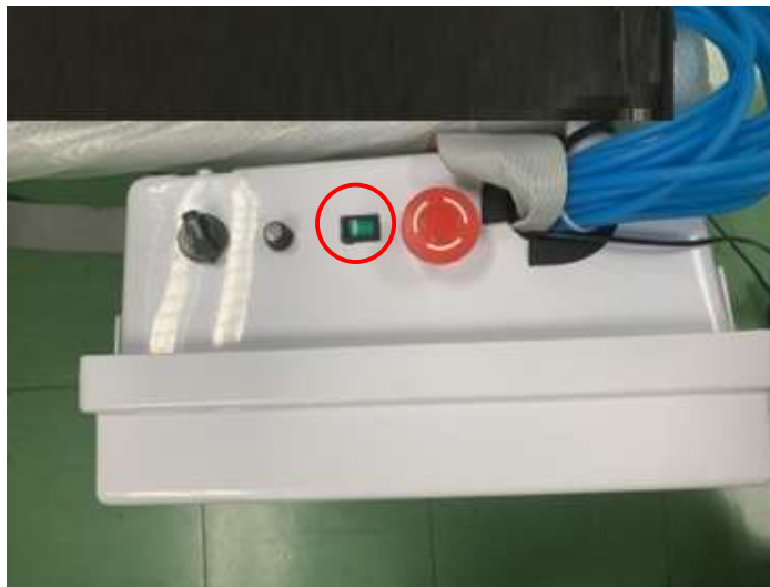
รูปที่ 6. สวิตช์ ใช้ในการเปิด-ปิดการทำงานของปั๊มลม
