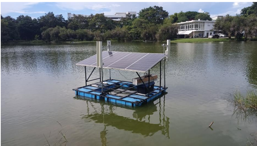
ภาพที่ 7.1 ทุ่นลอยน้ำให้บริการ Adhoc Network Gateway โดยใช้พลังงานแสงอาทิตย์
