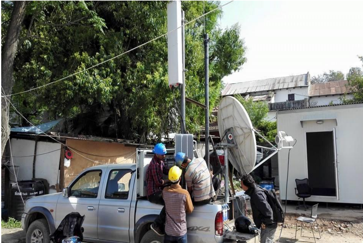
ภาพที่ 3.27 สถานีฐานโทรเคลื่อนที่แบบเคลื่อนที่ [74]
