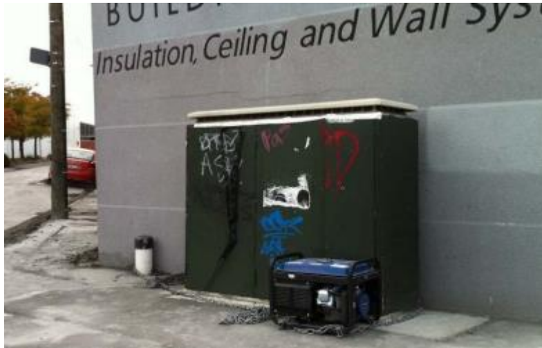
ภาพที่ 3.21 เครื่องกำเนิดไฟฟ้าจ่ายกระแสไฟฟ้าให้ตู้รวมและกระจายสัญญาณข้างถนน
