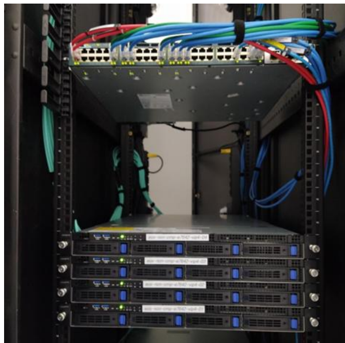
รูปที่ 13 สวิตช์ และเครื่องแม่ข่ายที่ดำเนินการติดตั้งไซต่นนทบุรี
