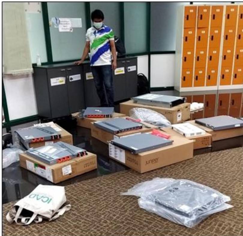
รูปที่ 11 การตรวจเช็คเครื่องก่อนนำเข้าติดตั้งที่ไซต่นนทบุรี (1)
