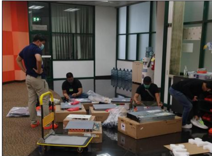
รูปที่ 12 การตรวจเช็คเครื่องก่อนนำเข้าติดตั้งที่ไซต่นนทบุรี (2)
