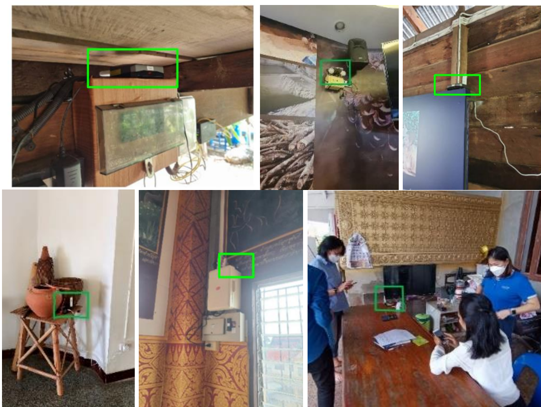
รูปที่ 96 การติดตั้งอุปกรณ์ Hardware Portable Device ณ พิพิธภัณฑ์เครือข่ายทั้ง 7 แห่งที่สภมูญาน อินเทอร์เน็ตไม่เสถียร
