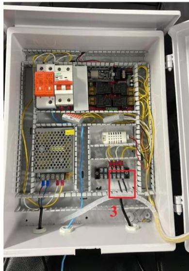
รูปที่ 5 ขั้นตอนการต่อสายโซลินอยด์วาล์วไปเสียบกับตัวปล่อยไฟที่ตู้ควบคุม 3
