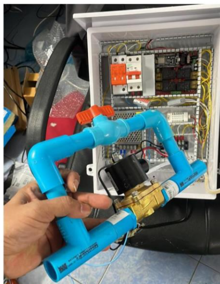
รูปที่ 3 ท่อน้ำระบบน้ำใหม่
